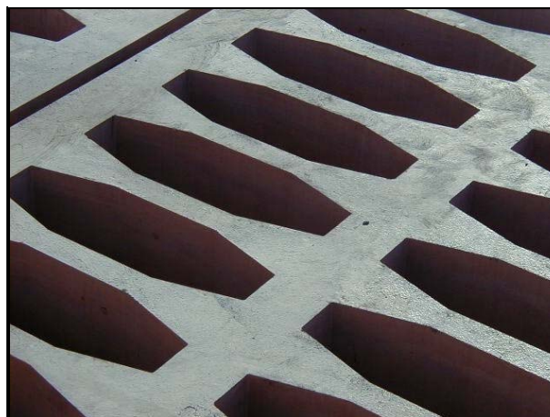
Bild 18: Ansicht der abgeriebenen Oberfläche eines Fertigteils
