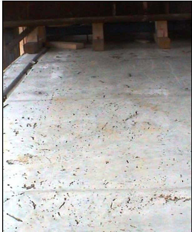
Bild 34: Bild der Laufspuren der aufsteigenden Luft an der Deckenschalung auf der Bogenoberseite
