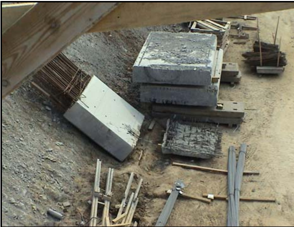
Bild 32: Zweiter Bogenstiel nach dem Rückbau. Links im Bild der oberste Teil mit der Anschlussbewehrung für den Überbau. Vorne unten der Rest nach Freilegen der Anschlussbewehrung des Betongelenks zwischen Widerlager und Bogenfuß
