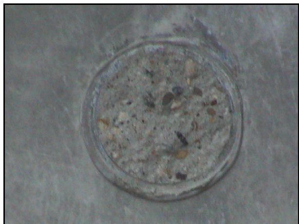
Bild 35: Sichtbeton am Einfüllstutzen
