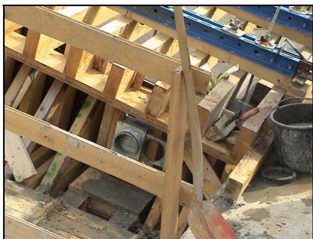
Bild 29: Einfüllstützen mit Schieber
