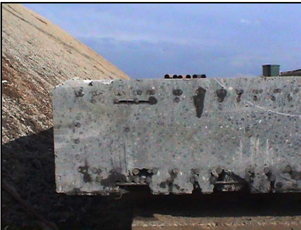
Bild 33: Sägeschnitt durch den Bogen. Oben links ist ein Luftporen an der oberen Bewehrung sichtbar, an der Unterseite die freiliegende Bewehrung
