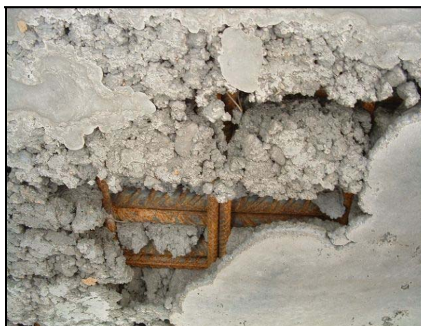
Bild 31: Untersicht des Festbetons im 2. Bogenstiel mit Blick auf die freiliegende Bewehrung
