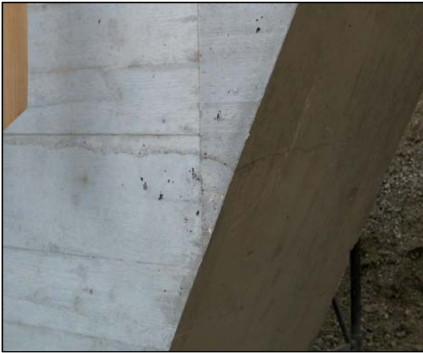
Bild 12: Sauber gebrochene Kanten, kleine Mörtelwülste und Luftporen
