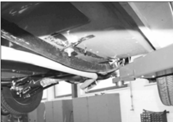
Bild 6.7a: Biegung des Unterbodenrahmens beim Bellier-Neufahrzeug
