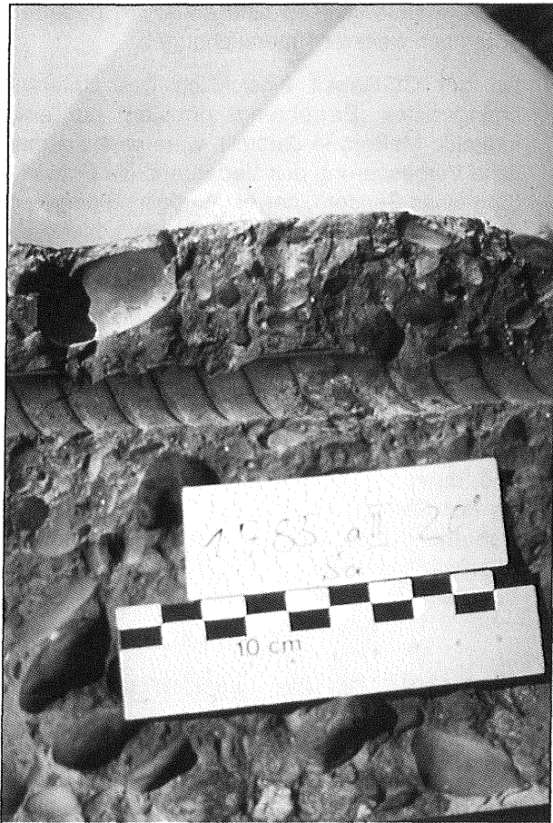
Abb. 44: Chloridionenverteilung nach Sprühverfahren, Blauverfärbungen im Stahlbett mit Abdruck einer Korrosionsstelle, entnommen aus [6]
