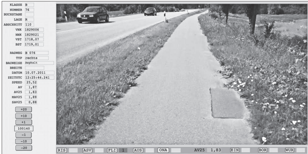
Bild 7-22: Beispiel für Radweg Typ „rechts“ der Bauweise Asphalt mit Flickstelle
