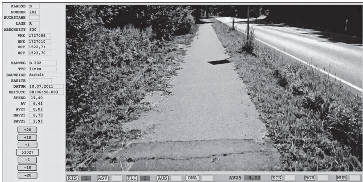
Bild 7-15: Beispiel für Radweg Typ „links“ der Bauweise Asphalt mit Riss und Flickstelle
