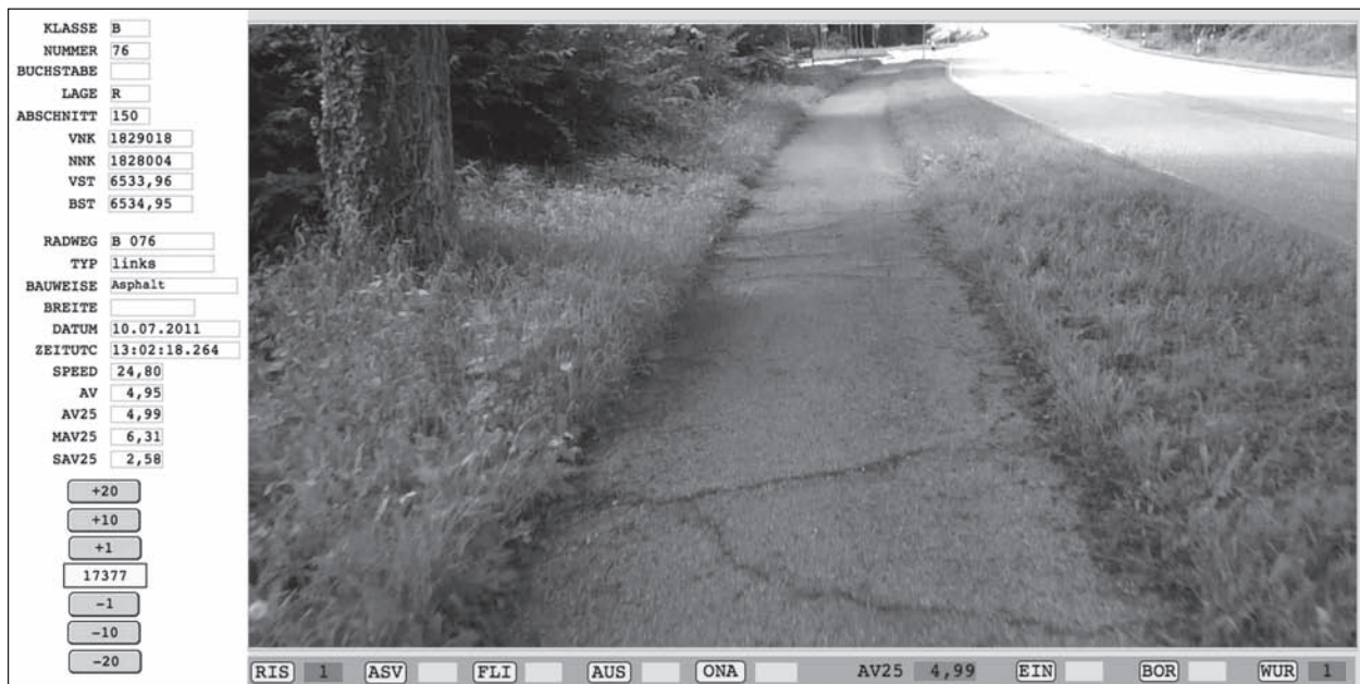
Bild 7-27: Beispiel für Radweg Typ „links“ der Bauweise Asphalt mit Riss und Wurzelhebung
