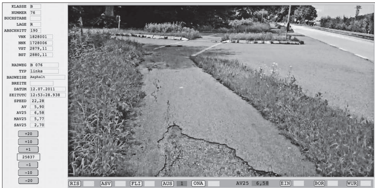
Bild 7-23: Beispiel für Radweg Typ „links“ der Bauweise Asphalt mit Ausbruch
