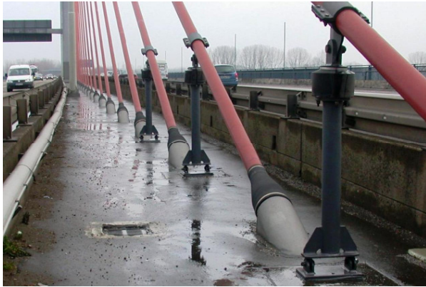
Bild 20: Dämpfer und Dichtungsmanschetten (Rheinbrücke Bonn-Nord)
