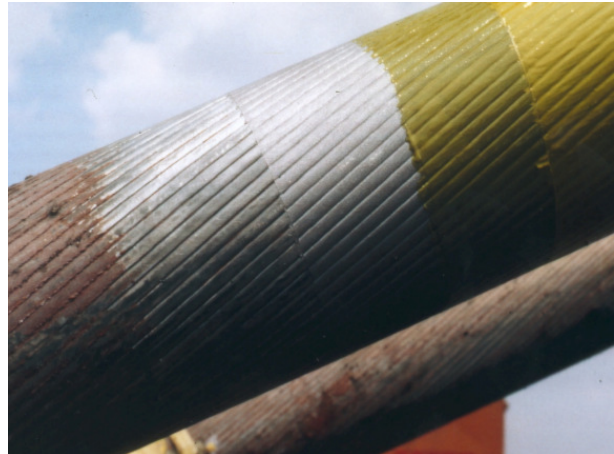
Bild 6: Mehrlagige Korrosionsschutzbeschichtung (auf einem vollverschlossenen Spiralseil)
