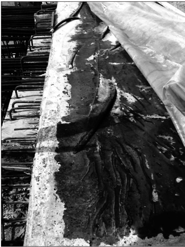
Bild 21: Festbetonoberfläche im Bereich der Entlüftungsschläuche der Hüllrohre
