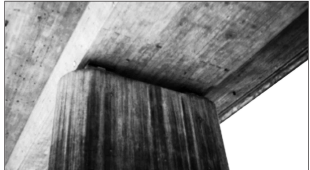
Bild 6: Unterschiedliche Farbe von Pfeiler und Überbau Buchloe. Foto: [32]
