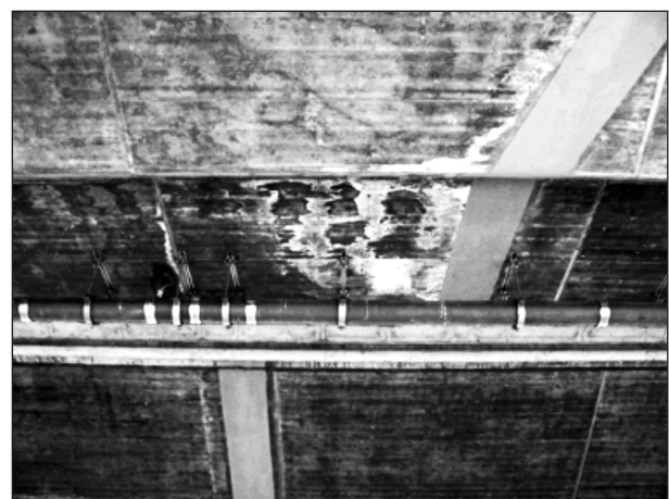
Bild 10: Aussinterung im Bereich der Koppelfuge im Jahr 2010
