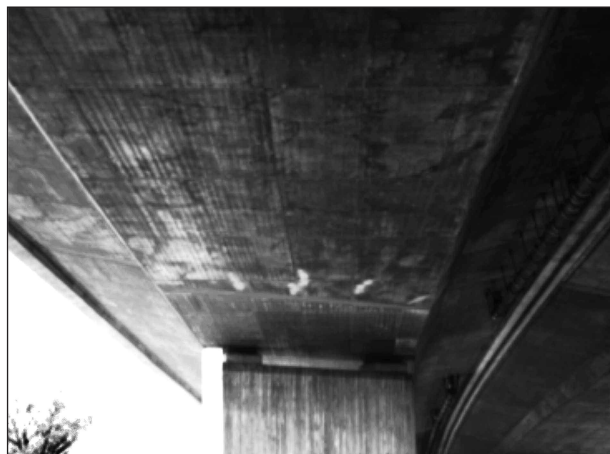
Bild 9: Verpresste Risse an der Koppelfuge im Jahr 2010
