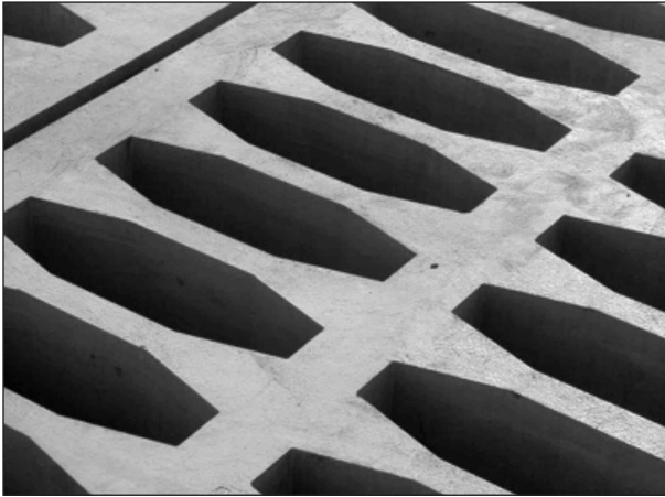
Bild 34: Ansicht der abgeriebenen Oberfläche eines Fertigteils
