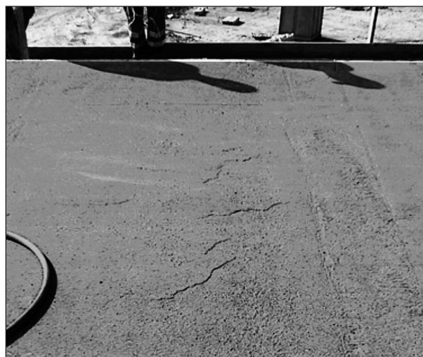
Bild 24: Risse im gereinigten Festbeton der Fahrbahntafel BW 51.1, Leipzig
