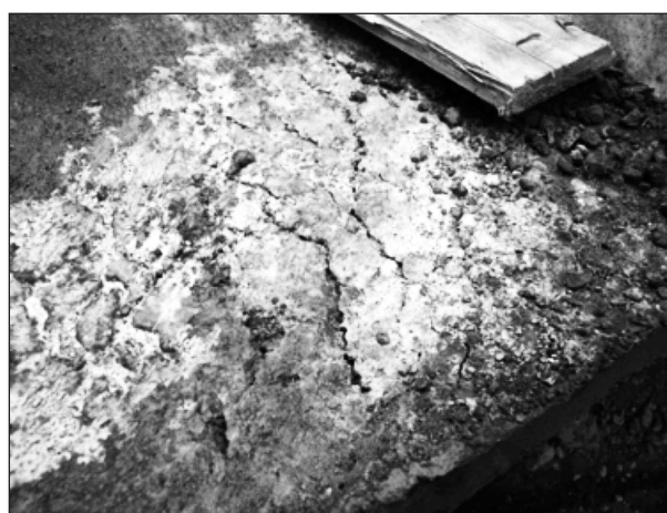
Bild 18: Kapillarschwindrisse bei der Probebetonage mit 40 m 3 C60/75 (Foto: Oberbauleitung Leipzig)
