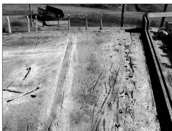
Bild 25: Eindrücke von Entlüftungsschläuchen und Folie im gereinigten Festbeton BW 51.1, Leipzig. Es sind auch Verdichtungsstellen sichtbar
