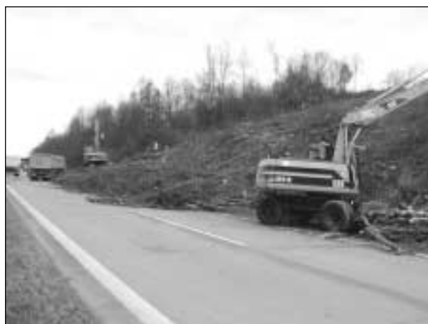
Bild 1: Räumung der Rutschmassen von der Fahrbahn
