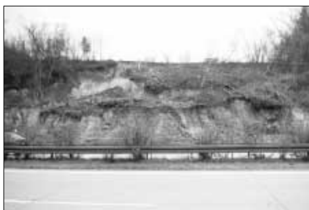
Bild 2: Ansicht der Rutschung nach Räumung der Fahrbahn
