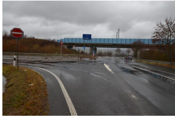
Abbildung 36: Haltlinie (Z 294 am Stoppschild) ist durch starke Abnutzung in schlechtem Zustand
