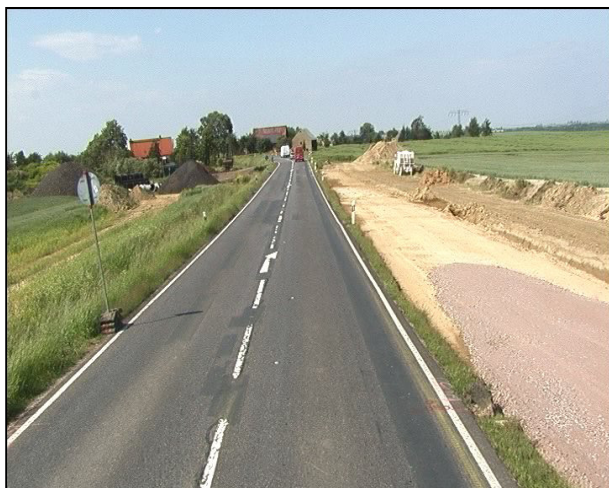
Abb. 2.7-1: B169, 4944 045 / 4944 047 St. 0,860 – VORHER (Quelle: ZEB 2004)
