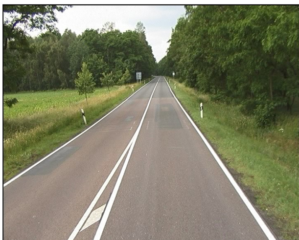
Abb. 2.6-3: B87, 4443 007 / 4443 004, St. 0,280 – VORHER (Quelle: ZEB 2004)
