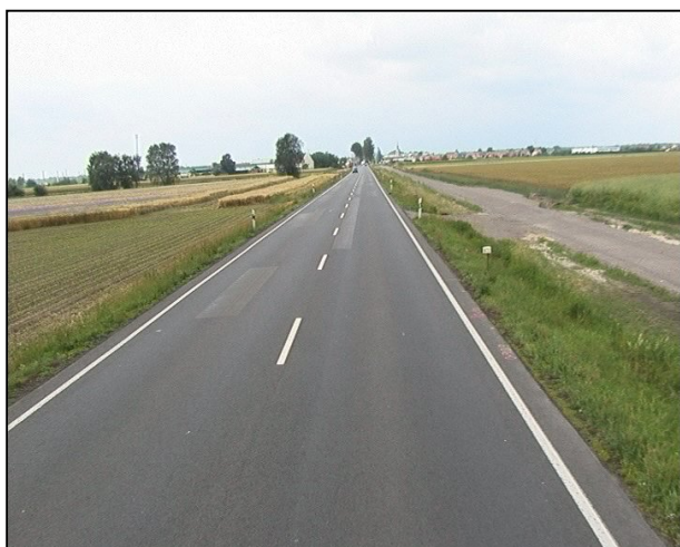
Abb. 2.6-1: B87, 4443 004 / 4442 008, St.1,000 – VORHER (Quelle: ZEB 2004)
