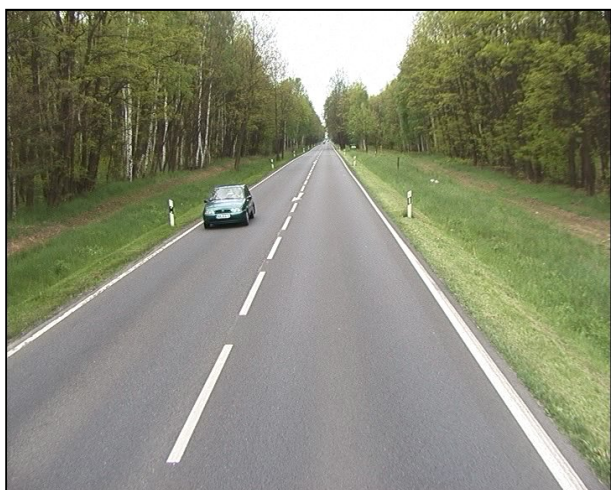
Abb. 2.8-3: B97, 4352 015 / 4352 019 St. 1,840– VORHER (Quelle: ZEB 2004)
