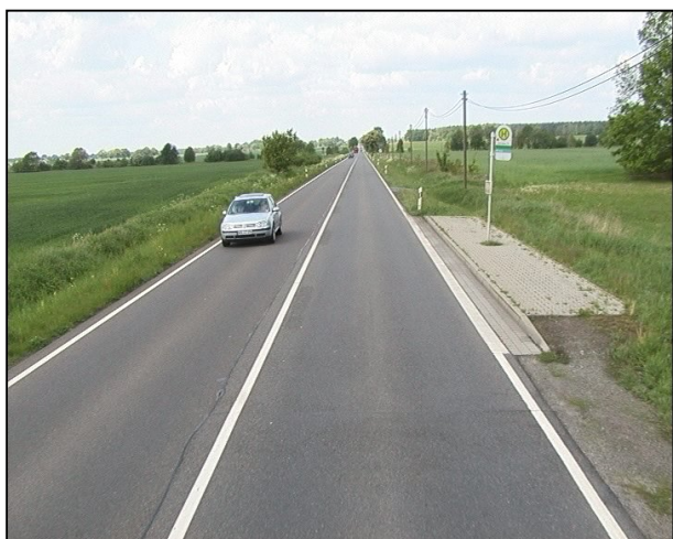
Abb. 2.8-1: B97, 4352 019 / 4352009 St. 0,996 – VORHER (Quelle: ZEB 2004)
