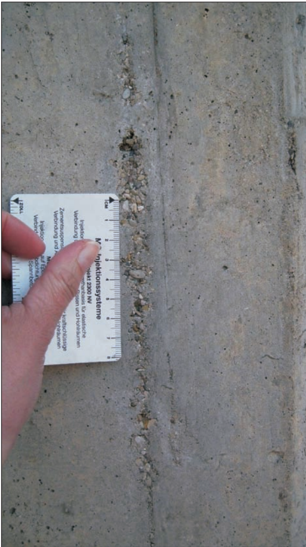
Bild 18: Kiesnest an Schalungsstoß
