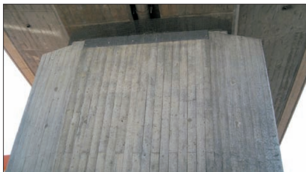
Bild 16: Leichte Verfärbungen im oberen Bereich des Pfeilers Achse 30
