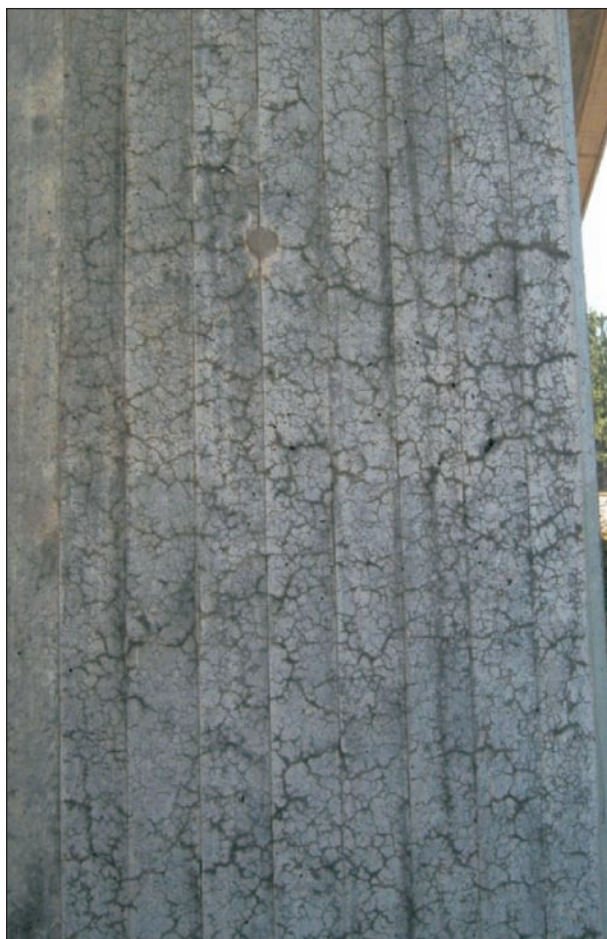
Bild 15: Netzrissbildung Pfeiler Achse 30
