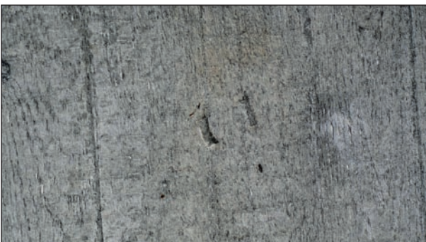
Bild 5: Vereinzelt sichtbare Abstandhalter an der Unterseite des Überbaus
