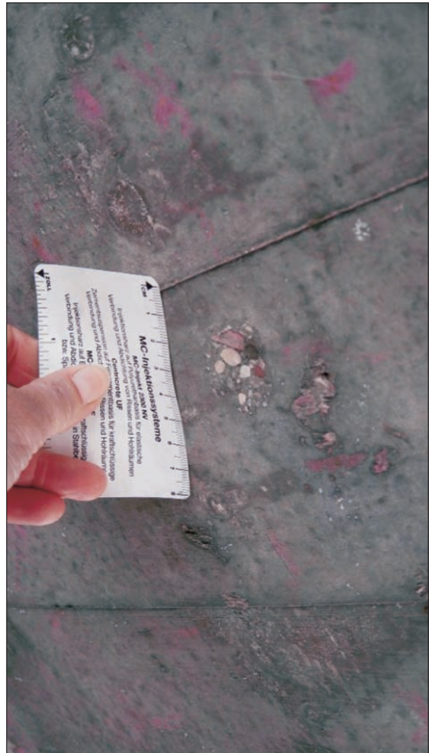
Bild 13: Abplatzungen geringen Umfangs an der Kragarmuntersicht des Überbaus
