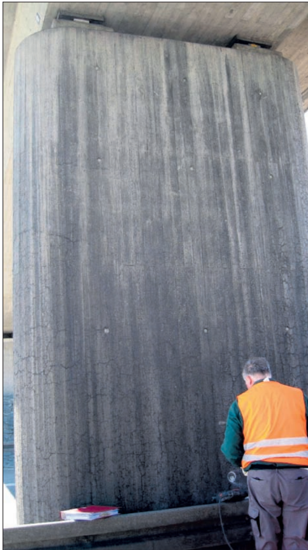
Bild 7: Dunkelfärbung des Pfeilers Achse 20
