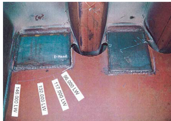
Bild 11: Riss wurde übertragen durch die Schweißnaht auf das Verstärkungsblech (vorhandene Risse werden vor dem Aufpflastern nicht zugeschweißt)
