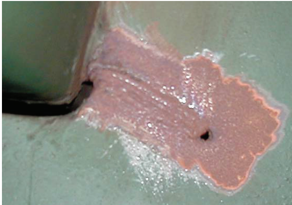
Bild 9. Durch Schweißen sanierter Riss, Autobahnbrücke Karlsruhe
