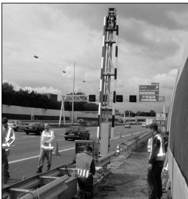
Bild 4.4: Notöffnung mittels Schranke im Schutzplankensystem
