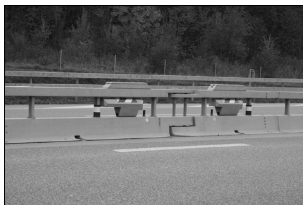
Bild 4.5: Schnellöffnungselement auf einer Überfahrt in der Schweiz
