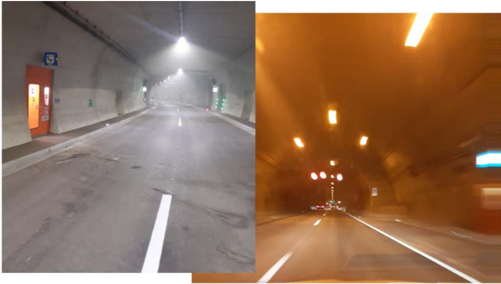
Bild 10: Sichtweite, Kontrast, visuelle Marker im Ereignistunnel (links) und zum Vergleich in einem seit längerem in Betrieb befindlichen Tunnel (rechts)
