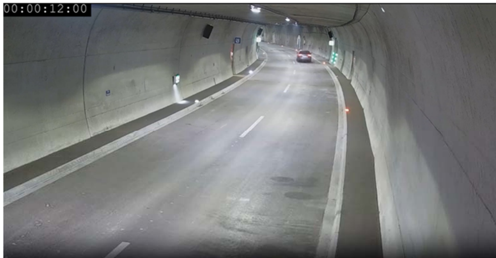
Bild 24: Erkennen der Schadstelle (EV6)
