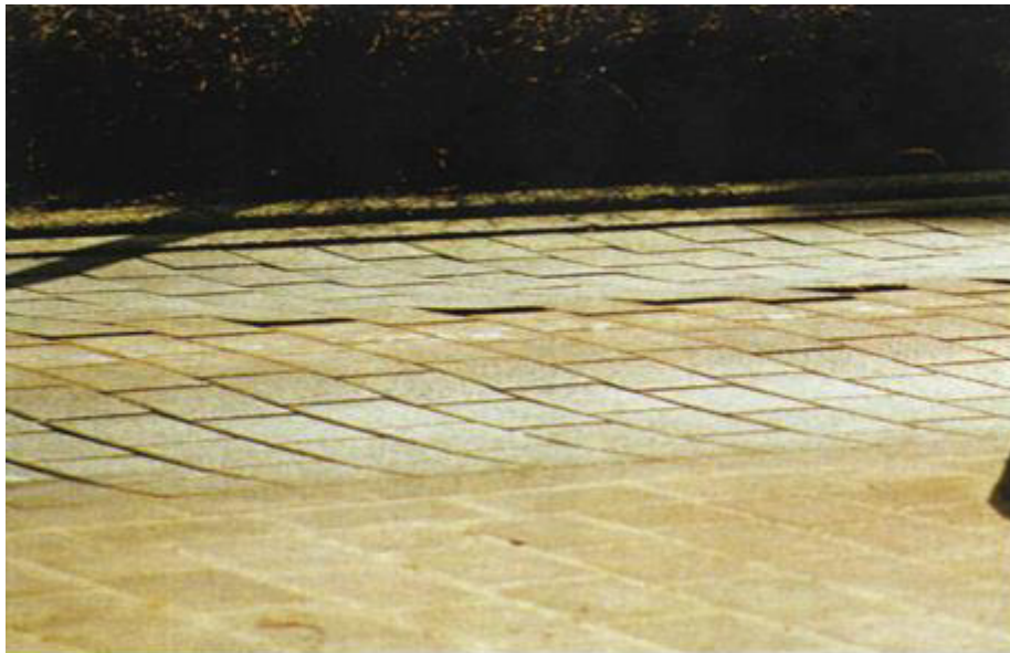
Bild 1-1: Typisches Schadensbild einer Pflasterbefestigung - Spurrinnenbildung/vertikale Verformungen im Bereich der Radspur
