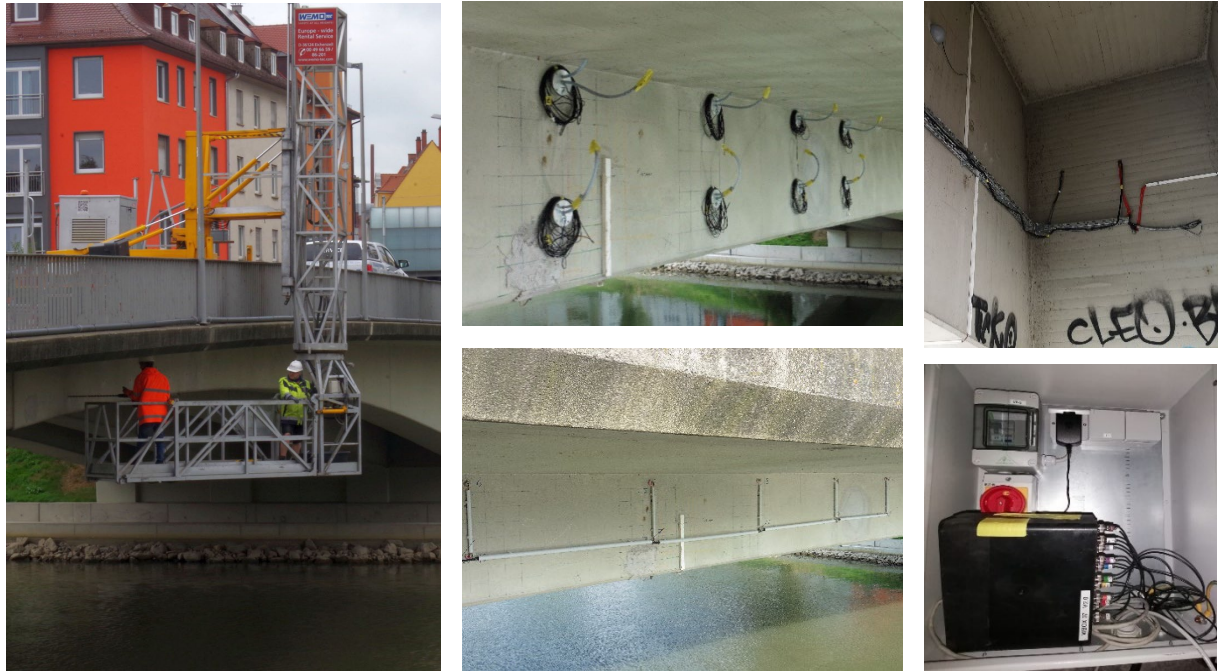
Bild 4.2: Transducermontage: Bohrungen (links), Zustand direkt nach Verpressen (oben Mitte) und nach Entfernen der Manschette und finaler Verkabelung (unten Mitte), Kabelführung ins Wiederlager (oben rechts) zur messenden W-Box (unten rechts) (Fotos BAM).
