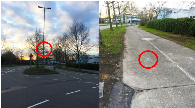
Bild 49: SWS Karlsruhe Ostring, Beleuchtungsmast mit Sensorik für atmosphärische Parameter und Kamera (links), Sensor im Radweg (rechts) (Bild: HOLLDORB)
