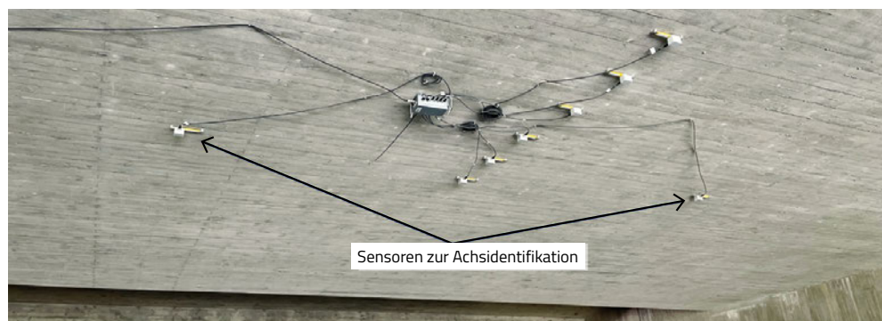
B-WIM System installiert an der Unterseite eines Brückenbauwerks.
