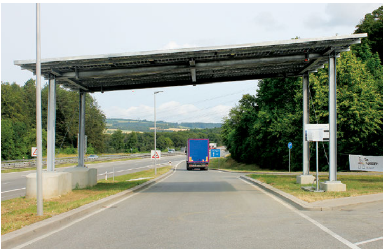
PV-Überdachung an der BAB A 81 Tank & Rastanlage Hegau-Ost.
