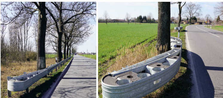
Passive Schutzeinrichtungen neben Bäumen.
