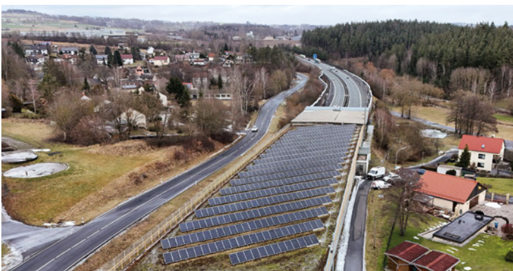
PV-Anlage auf der Einhausung Unterweißenbach an der BAB A93 bei Selb.
