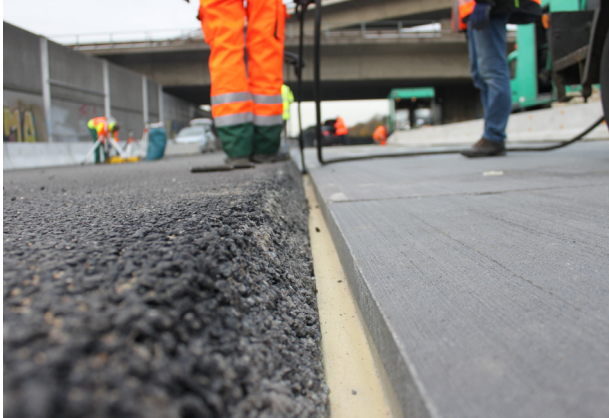
Bild A.84: Fuge zwischen Asphalt und Fertigteil
