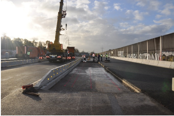
Bild A.1: Einbauort zu Beginn der Arbeiten am 13.11.2017
