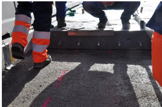
Bild A.24: Aufwölbung in der Asphalttragschicht am Rand zum Kabelschacht
