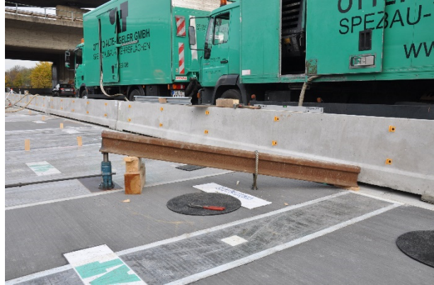
Bild A.68: improvisierte Höhenjustierung aufgrund der verrutschten Stahlplatte
