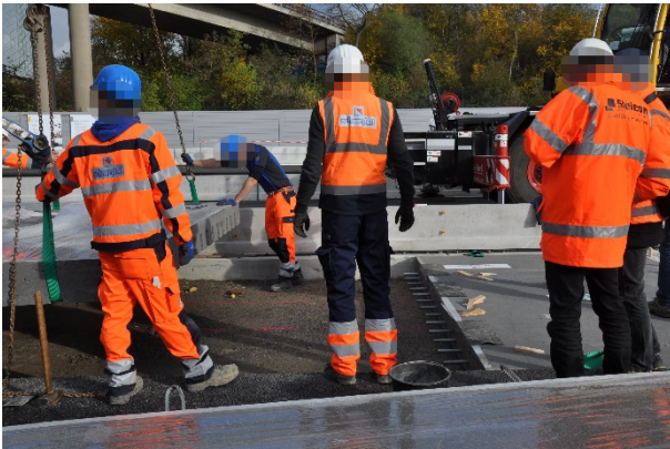
Bild A.33: Einsetzen von Platte 6 nach Höhenanpassung mit der Hilfe mehrerer Stahlplatten
