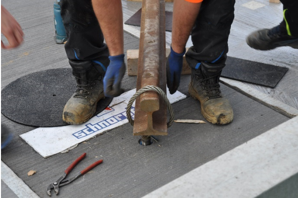
Bild A.67: improvisierte Höhenjustierung aufgrund der verrutschten Stahlplatte
