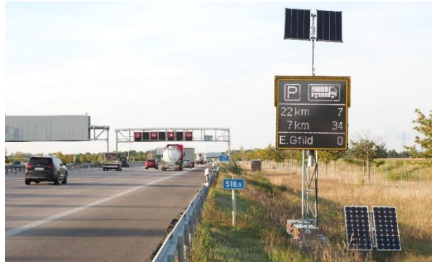
Abbildung 2: Foto einer LED-Anzeige für die Rastanlage Echinger Gfild auf der A9 in Fahrtrichtung Nürnberg [Quelle: Landesbaudirektion Bayern, Zentralstelle Verkehrsmanagement]
