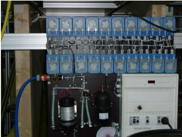
Bild 3-6: Detailaufnahme des Pumpensystems und der Steuerungseinheit
