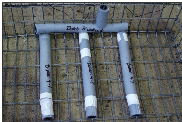
Bild 4-1: Isolierte Kabel im Bodengitter
