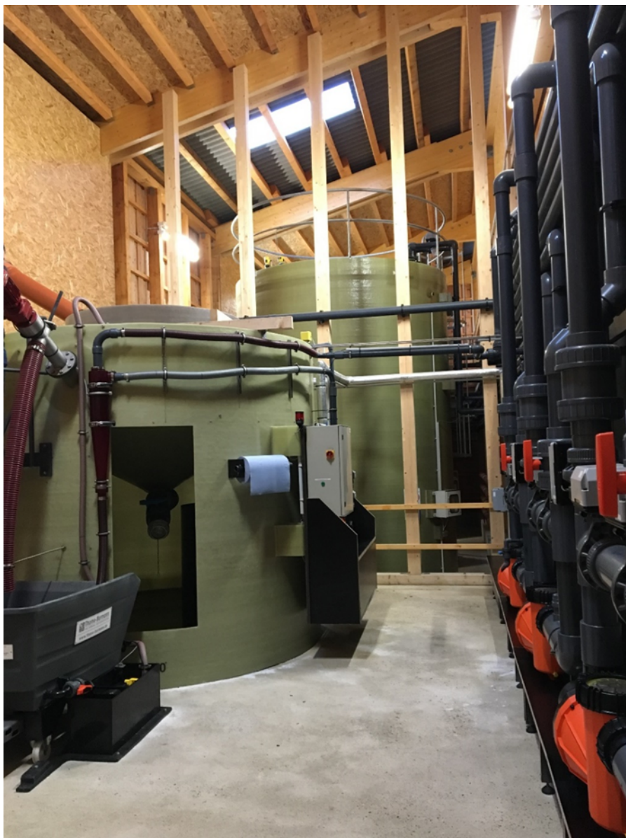
Bild 26: Tausalzlöseanlage in der AM Kaisersesch
