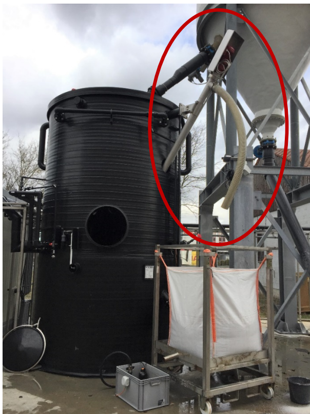
Bild 45: Upflow-Löseanlage mit Abschlämmschnecke, Auffang-BigBag und Solerückführung in der AM Erlangen
