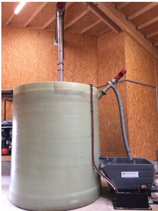
Bild 53: Soleerzeuger mit Abschlammrohr und -schnecke sowie Entwässerungscontainer
