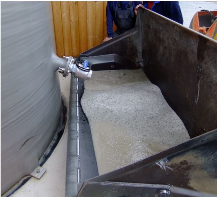
Bild 55: Manuelles Abschlämzen über die Abschlämmlleitung in eine Radladerschaufel
