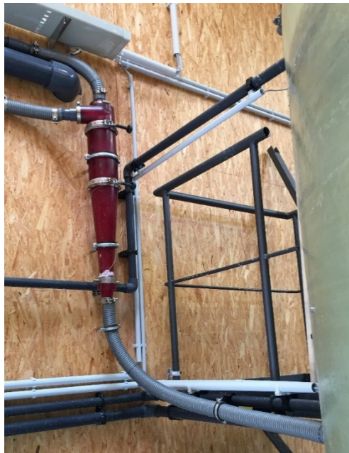
Bild 56: Hydrozyklon für die Solereinigung
