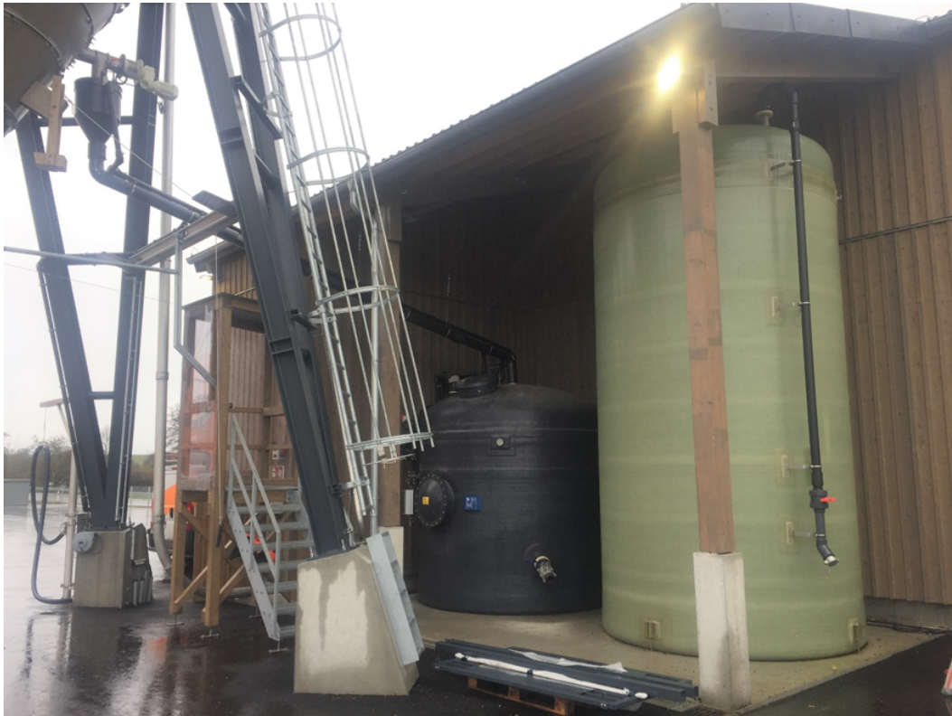
Bild 31: Tausalzlöseanlage in der SM Bad Rappenu
