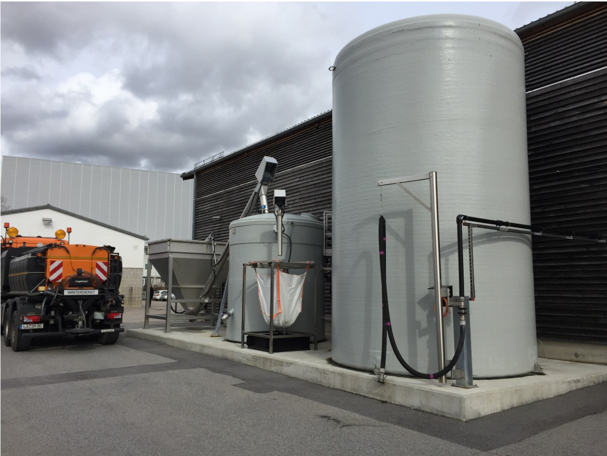
Bild 51: Tausalzlöseanlage in der SM Dingolfing
