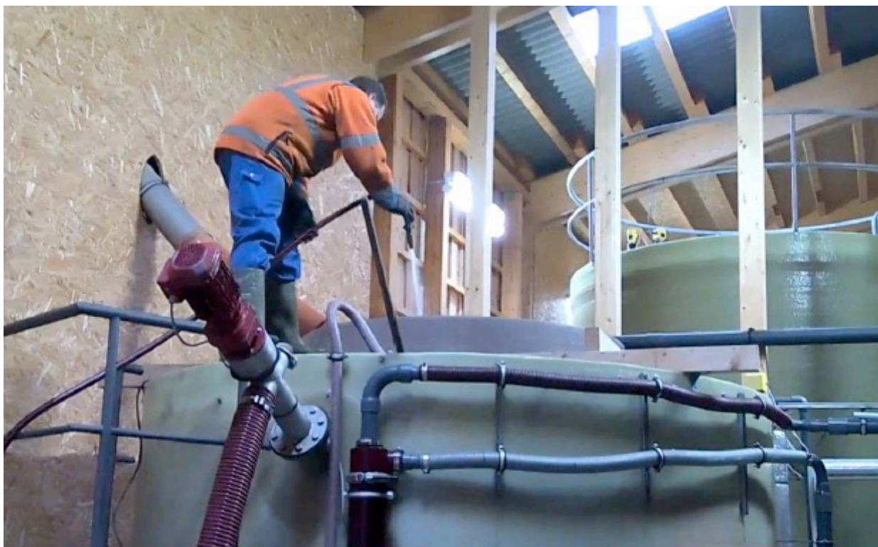
Bild 49: Erhöhte Unfallgefahr durch fehlende Podeste und Geländer
