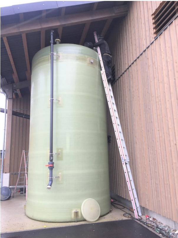
Bild 50: Erhöhte Unfallgefahr bei der Entnahme einer Soleprobe aus dem Lagertank unter Zuhilfenahme einer Anstellleiter
