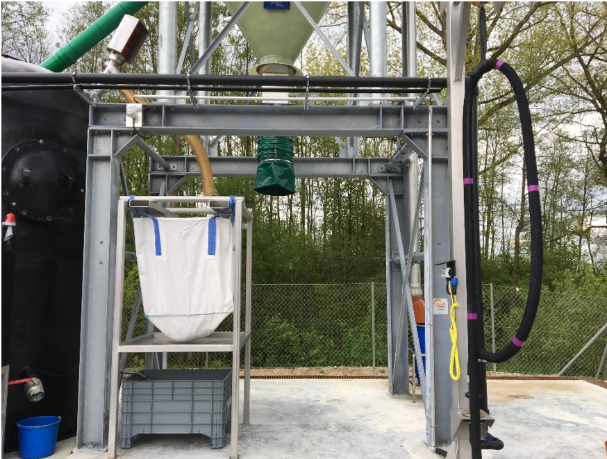
Bild 54: Abschlämzung mit einer Abschlämmschnecke in einen BigBag
