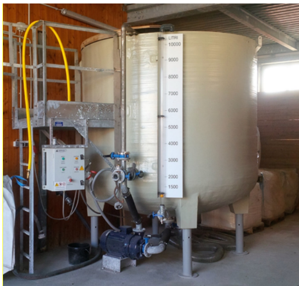
Bild 7: Tausalzlöseanlage nach dem Zirkulationsverfahren im Bauhof Fürstenfeldbruck
