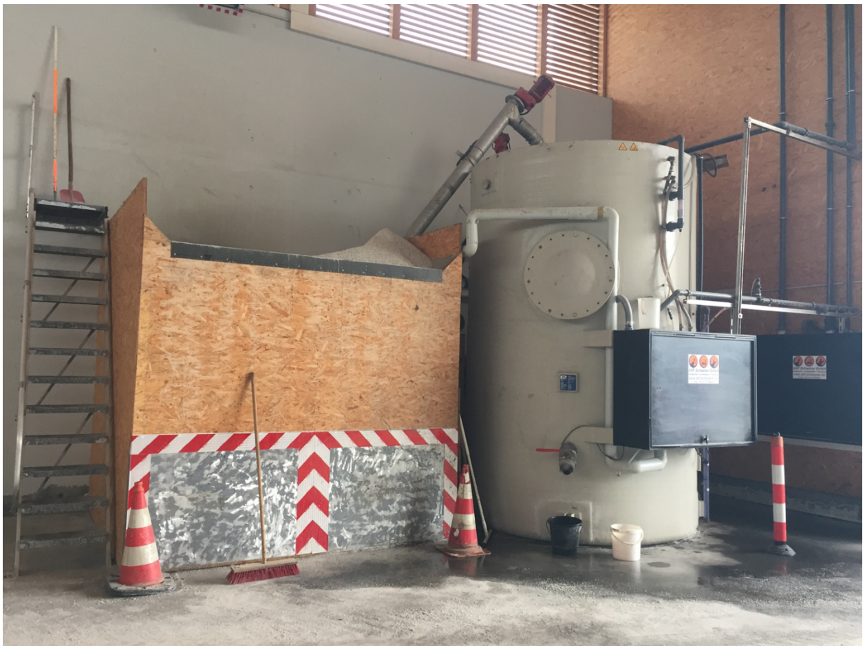
Bild 5: Tausalzlöseanlage nach dem Upflow-Prinzip in der AM Rottweil
