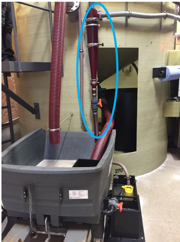
Bild 47: Upflow-Löseanlage mit Hydrozyklon, Abschlämmschlauch, Auffangcontainer und Solerückführung in der AM Kaisersesch
