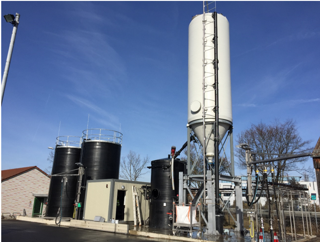
Bild 27: Tausalzlöseanlage in der AM Erlangen
