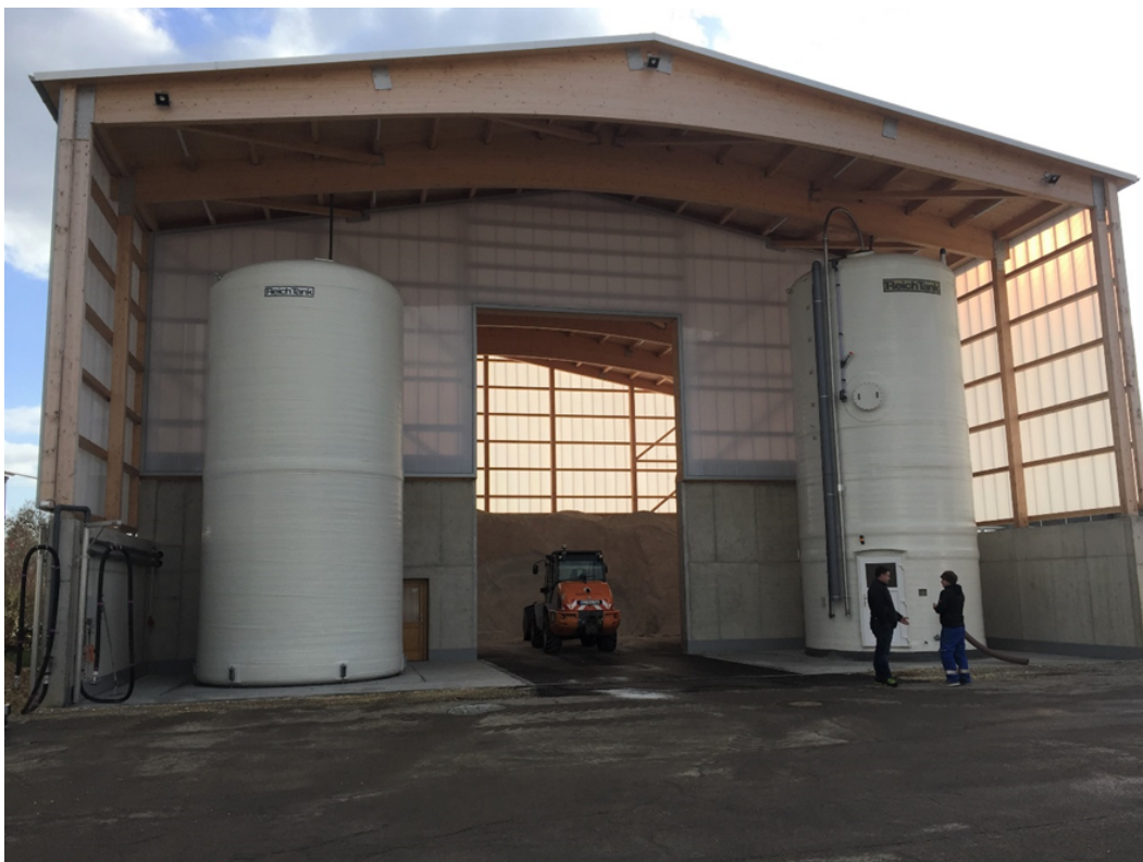
Bild 29: Tausalzlöseanlage in der SM Dillingen
