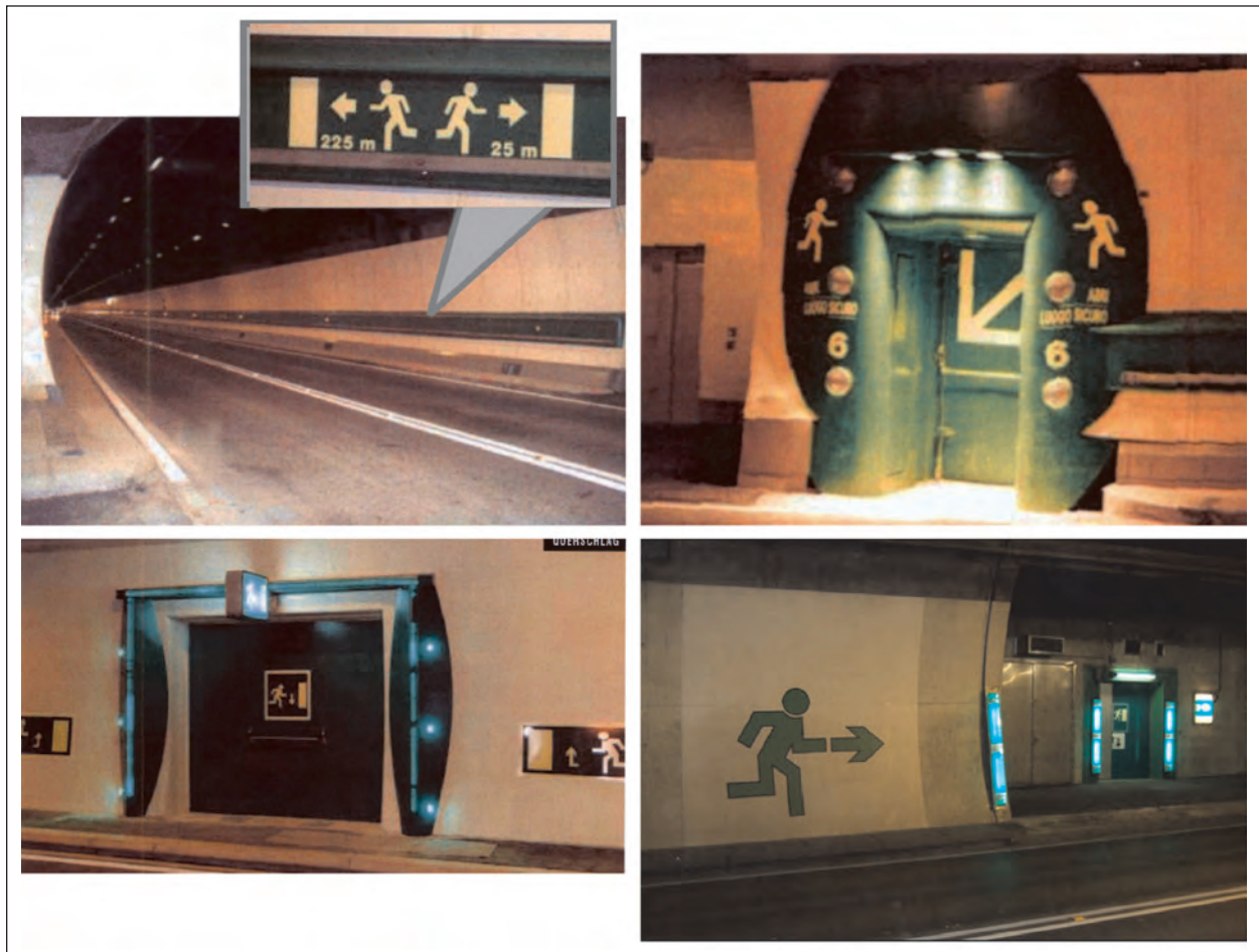
Bild 7.7: Oben: Fluchtwegkennzeichnung (reflektierend, nachleuchtend, alle 50 m) und Gestaltung eines Notausgangs im Montblanc-Tunnel; unten links: Notausgang (Querschlag) im Gamsentunnel, Schweiz (aus: STEINAUER et al., 2007, S. 55 f.). Unten rechts: Fluchtwegkennzeichnung und Notausgang in der Schweizer Galleria Mappo-Morettina (aus: http://www.adac.de/Tests/Mobilitaet_... )
