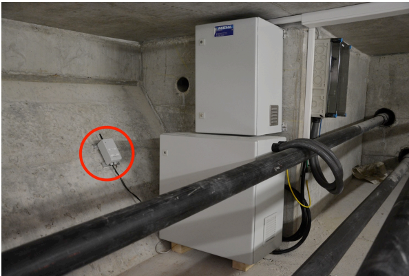
Bild 4.4: Gateway des Sensornetzes neben dem Schaltschrank der Universität zu Lübeck (Fischer et al. 2017)
