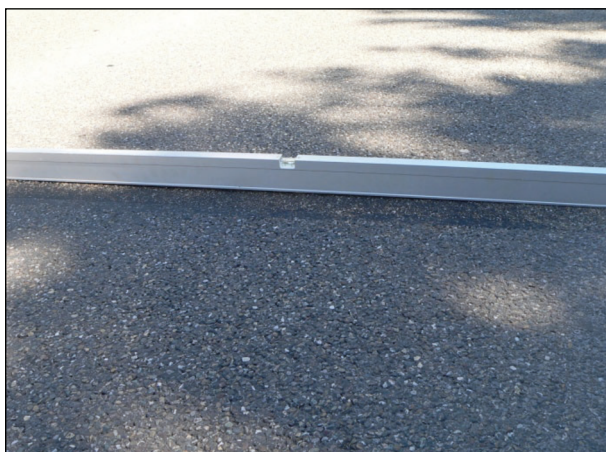
Bild 34: 20 cm breite Belagsdehnfuge nach 10 Jahren unter Verkehr - keine Verformung in Querrichtung (1)
