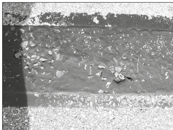
Bild 78: Freigelegte grobe Gesteinskörnung in der Rollspur der Belagsdehnfuge bei Waldkirch nach 4 Jahren unter Verkehr (1)
