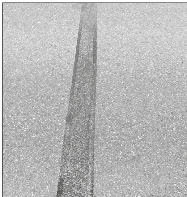
Bild 62: 19 cm breite und schadensfreie Belagsdehnfuge nach 3 Jahren unter Verkehr (1)
