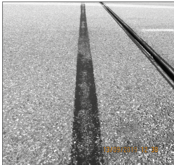
Bild 82: Belagsdehnfuge der Brücke über die Steina im Zuge der BAB A 98 vor einem Stahlbahnübergang nach 10 Jahren unter Verkehr ohne Schäden (6)
