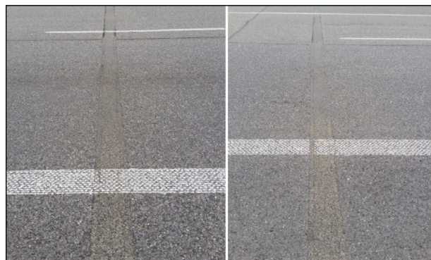
Bild 111: Belagsdehnfugen im Zuge der B 500 über einen Baggersee bei der Schleuse Iffezheim nach 6 Jahren unter Verkehr ohne Schäden (14)
