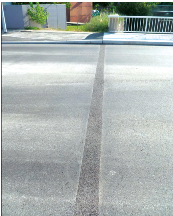
Bild 44: Belagsdehnfuge bei Fertigstellung in 2012 (4)
