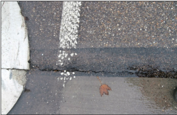
Bild 108: Enthaltungen zur Betonfahrbahn im nicht überfahrenen Bereich (13)
