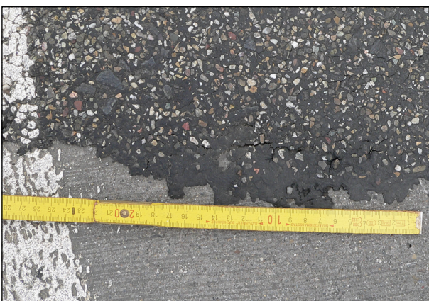
Bild 64: Riss an der Grenzfläche zum Beton am Abzweig Rottweiler Straße nach 7 Jahren unter Verkehr (1)
