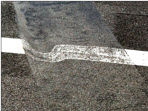
Bild 1: Verformung in einem Fahrbahnübergang aus Asphalt (1)
