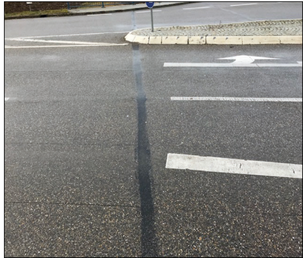
Bild 93: Belagsdehnfuge an der Wedelbrücke im Zuge der B 466 (9)
