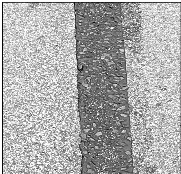
Bild 88: Belagsdehnfuge mit Ablösungen zum Asphalt nach 10 Jahren unter Verkehr (7)
