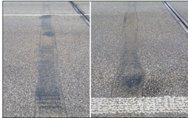
Bild 109: Belagsdehnfugen im Zuge der B 500 über den Rheinwasserkanal bei Wintersdorf nach 4-5 Jahren unter Verkehr ohne funktionale Schäden (14)
