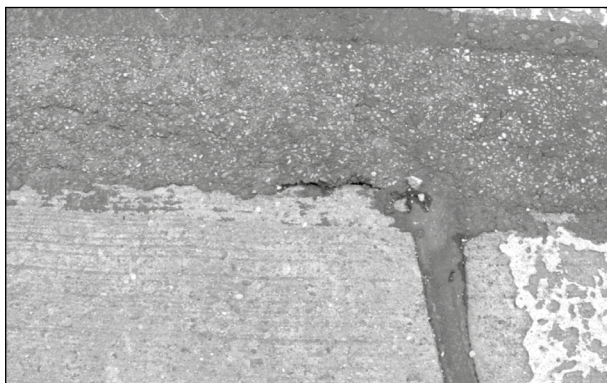
Bild 58: Geringfügige Ablösungen zum Beton in Fahrbahnmitte auf der B 27 nach 5 Jahren unter Verkehr (1)
