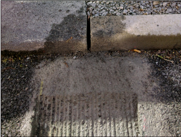
Bild 14: Auslaufen der Fugenmulde an der Brückenkappe (1)
