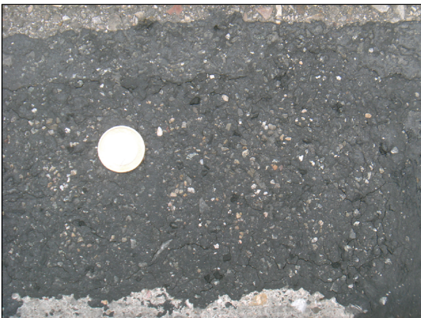
Bild 101: Versprödung und oberflächliche Risse (12)
