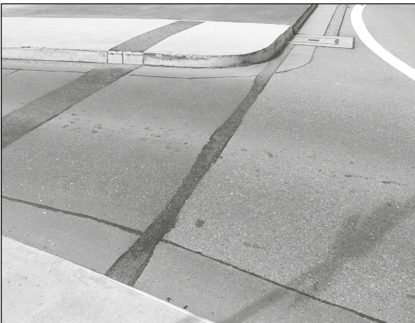
Bild 40: 14 cm breite Belagsdehnfuge vor einem Kreisverkehr nach 10 Jahren unter Verkehr ohne Verformungen (1)
