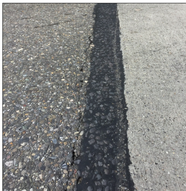
Bild 92: Risse im angrenzenden Asphalt und erkennbares Korngerüst nach 9 Jahren unter Verkehr (8)
