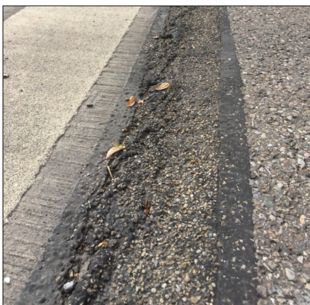
Bild 90: Belagsdehnfuge mit Versprödungen nach 9 Jahren unter Verkehr (8)
