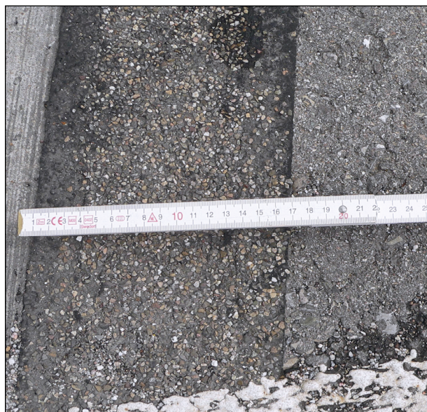
Bild 57: Schadensfreie Belagsdehnfuge auf der kommunalen Oberndorfer Straße nach 5 Jahren unter Verkehr (1)
