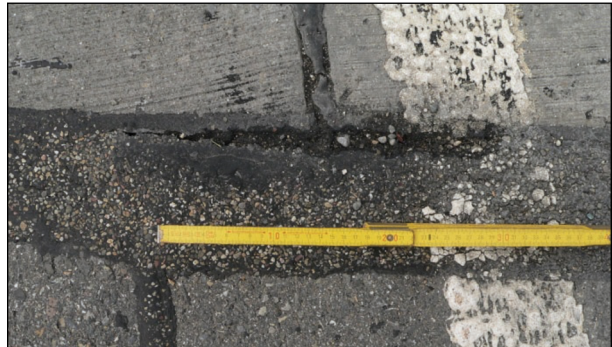
Bild 65: Riss an der Grenzfläche zum Beton am Abzweig Fahrtrichtung Tuttlingen nach 7 Jahren unter Verkehr (1)
