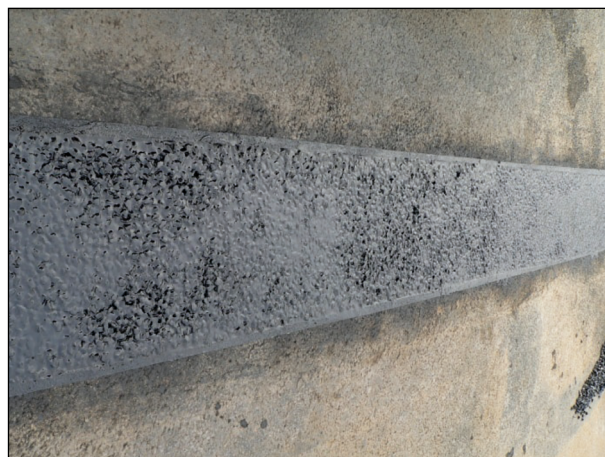
Bild 27: Bildung von Hohlräumen durch Absacken der Tränkmasse im Gesteinskörnungsgüst (1)
