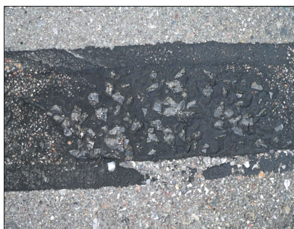
Bild 71: Freigelegte Gesteinskörnungen in der Rollspur der ca. 19 cm breiten Belagsdehnfuge nach 3 Jahren unter Verkehr (1)
