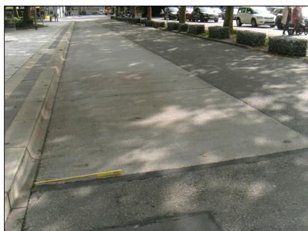
Bild 99: Belagsdehnfuge nach 7 Jahren unter Verkehr, mit ca. 60 cm langen Ablösung am Übergang zum Beton (12)
