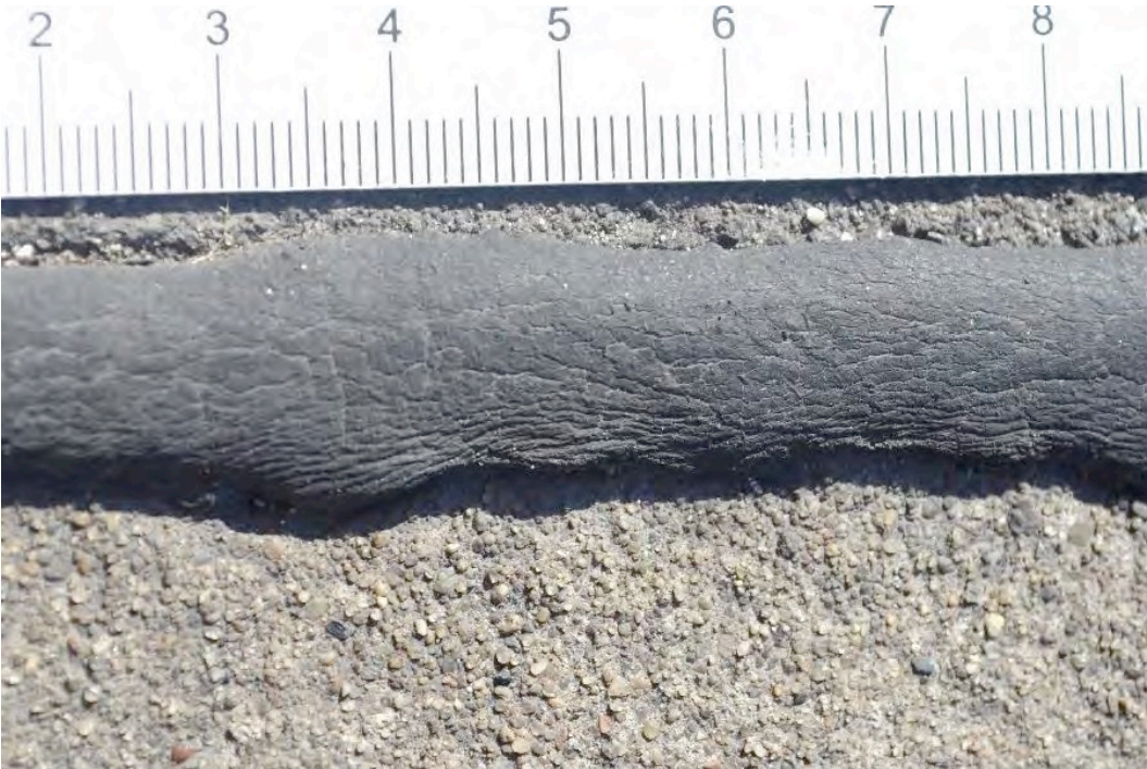
Bild 221: Oberflächlich versprödete Fugenmasse (A7)
