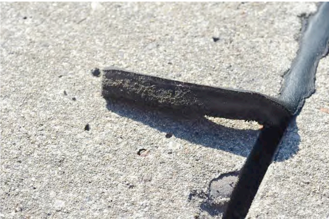
Bild 222: Herausgelöste Fugenmasse (A7)
