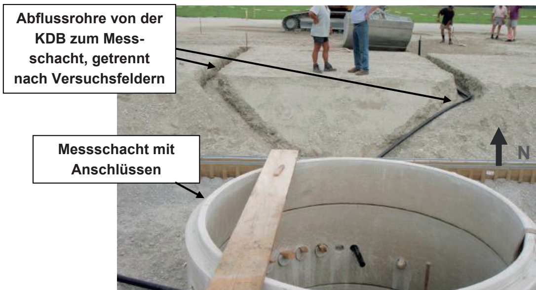
Abbildung 4.8: Anschlüsse in der Aufstandsfläche der Versuchsschüttung
