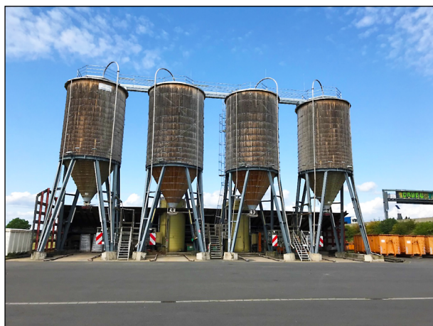
Bild 40: Siloanlage mit 4 Holzsilos der AM Rodgau (Bild: Holl-dorb)
