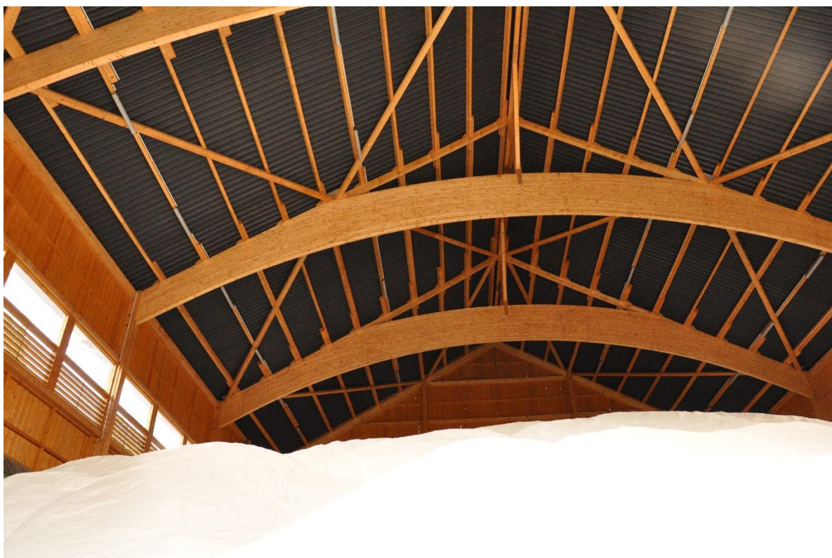
Streustoffhalle AM Reiskirchen: Innenansicht Dachkonstruktion (Bild: Pape)
