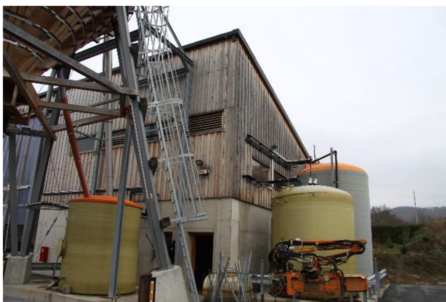
Streustoffhalle SM Northeim: Salzlöseanlage mit Lagertanks (Bild: Cypra)
