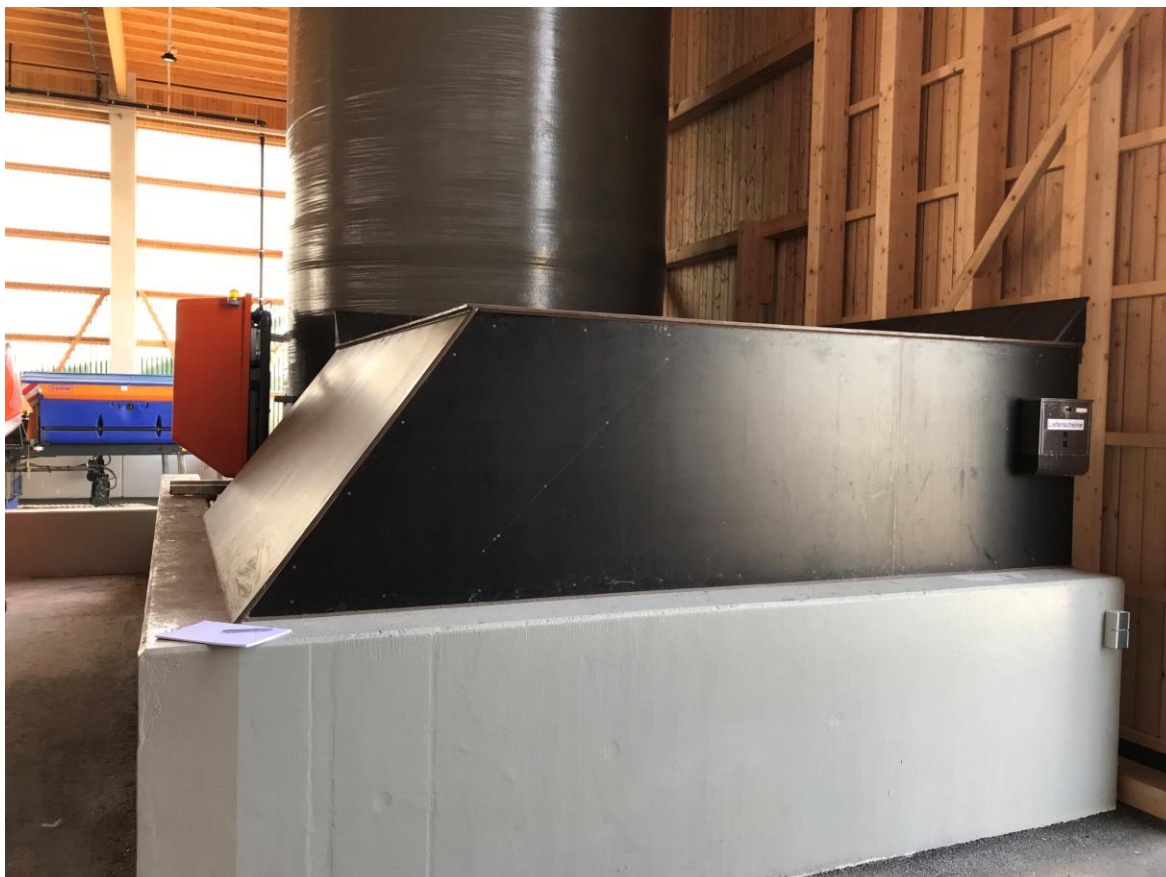
Streustoffhalle SM Münsingen, gekapselter Trichter der Salzlöseanlage (Bild: Holldorb)
