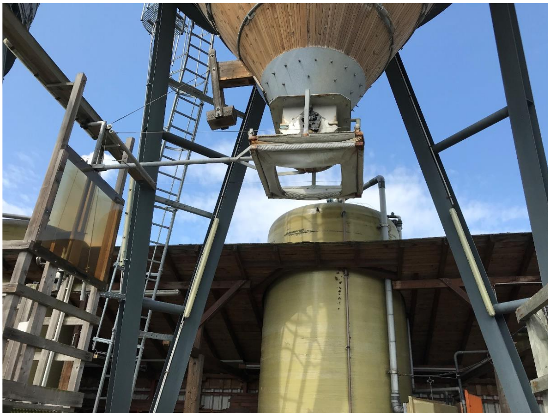
Siloanlage AM Rodgau: Siloauslass mit Schürze gegen Verwehungen (Bild: Holldorb)
