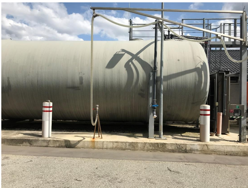
Streustoffhalle AM Reiskirchen: Soletank mit Soleanschluss und Anfahrerschutz (Bild: Holldorb)
