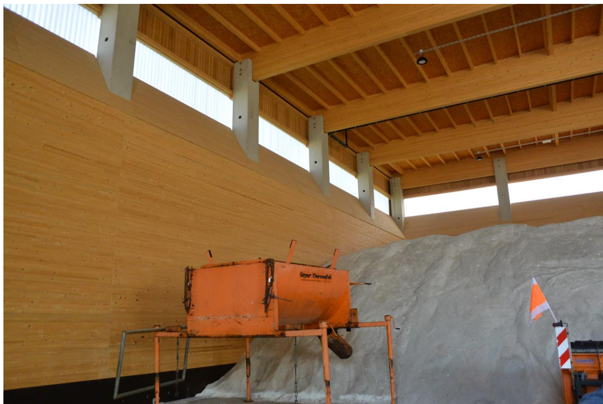
Streustoffhalle SM Münsingen, Innenansicht, Salzlagerbereich (Bild: Pape)
