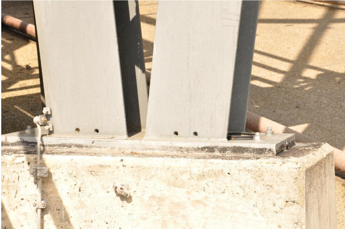
Siloanlage AM Rodgau: Bohrung an den Stützenfüßen zur Vermeidung von Korrosion (Bild: Pape)
