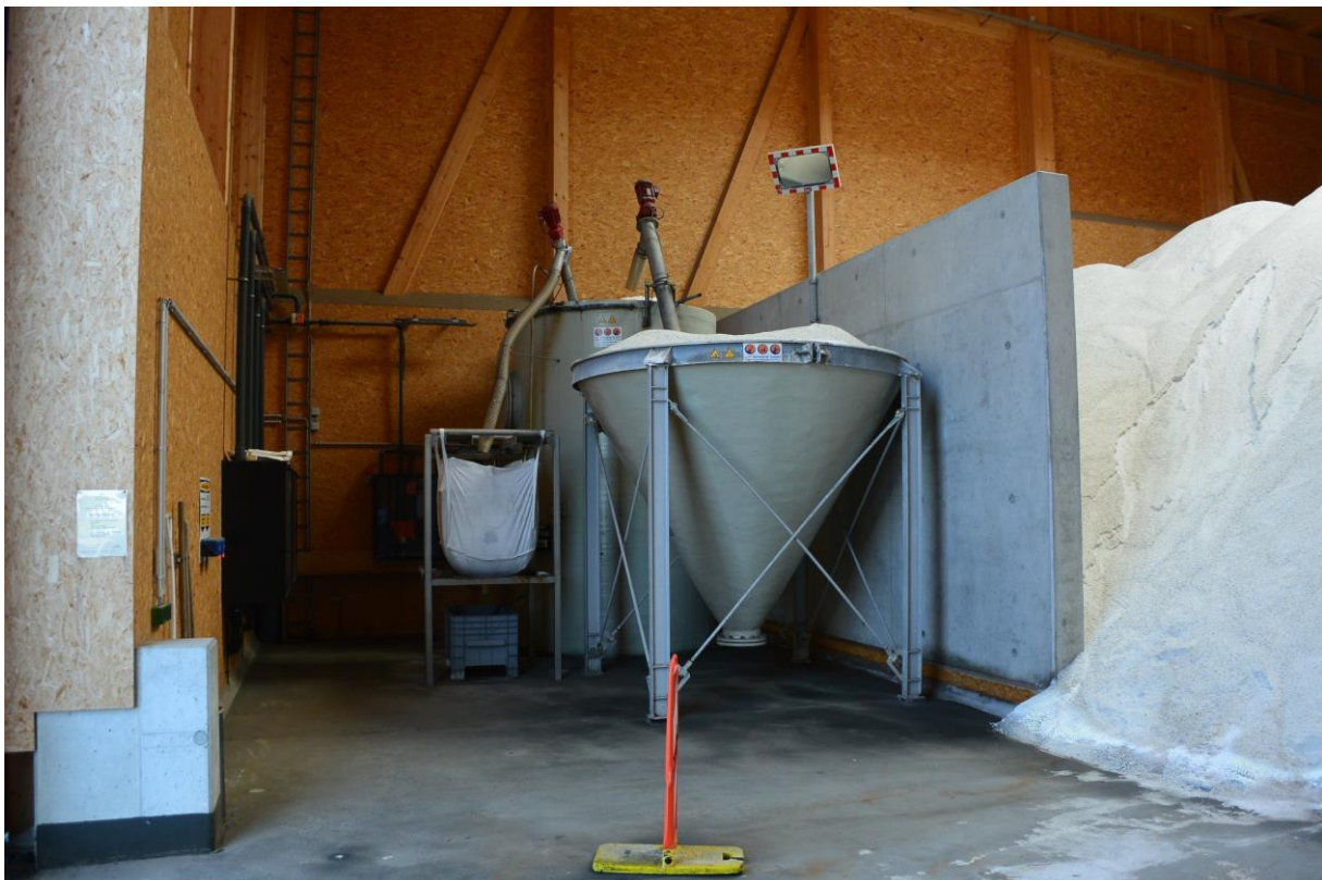
Streustoffhalle AM Kirchheim/Teck, Salzlöseanlage mit Trichterbeladung in der Halle (Bild: Pape)
