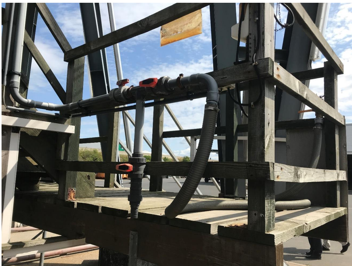
Siloanlage AM Rodgau: Anschluss für die Solebetankung (Bild: Holldorb)
