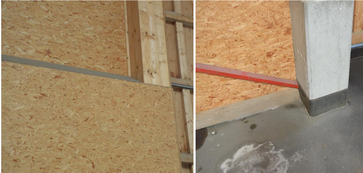
Streustoffhalle AM Kirchheim/Teck, Abdichtung der Innenholzverschalung gegenüber der Betonkonstruktion oben und im Sockelbereich (Bilder: Pape)
