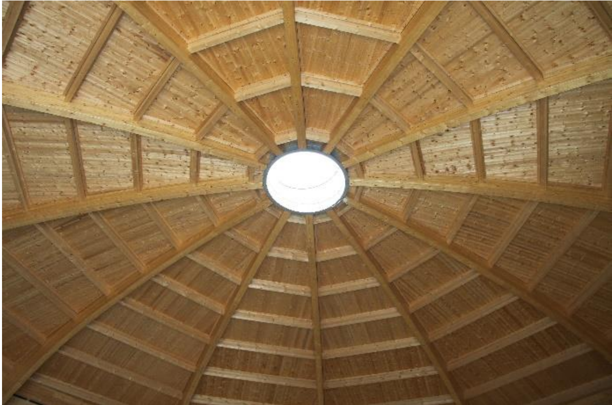
Streustoffhalle AM Efringen-Kirchen: Belüftung der Halle (Bild: Cypra)
