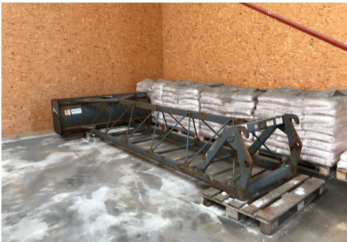
Streustoffhalle AM Kirchheim/Teck, Teleskopschiebeeinrichtung zur Einlagerung des Streusalzes bis auf eine Schütthöhe von 6 m (Bild: Holldorb)
