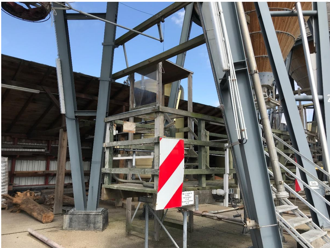
Siloanlage AM Rodgau: Podest zur Bedienung des Siloauslasses als Holzkonstruktion mit Stahlgitterrosttreppe (Bild: Holldorb)
