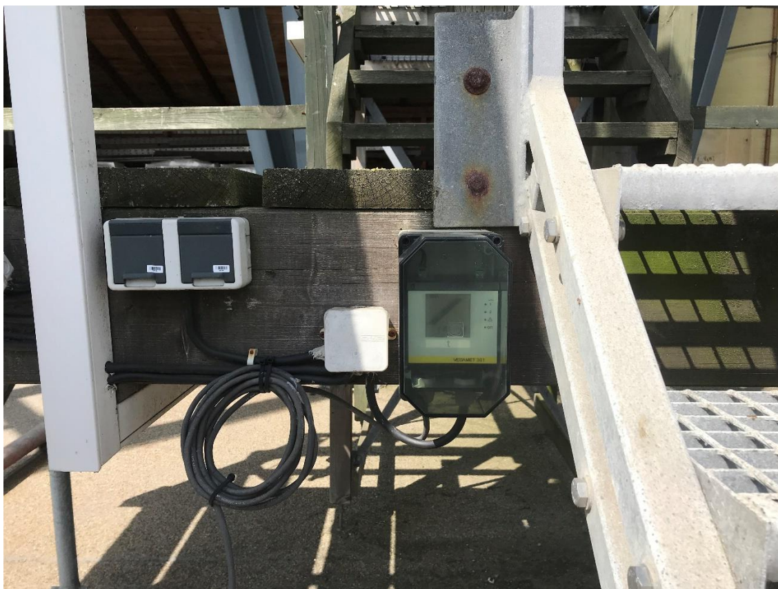
Siloanlage AM Rodgau: Füllstandsanzeige Streustoffsilo (Bild: Holldorb)
