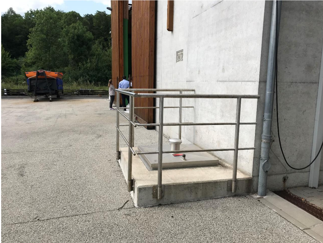
Streustoffhalle AM Reiskirchen: Zugangsschacht zum unterflur eingebauten Beladetrichter und Zulaufschlauch zum Verladesilo (Bild: Holldorb)
