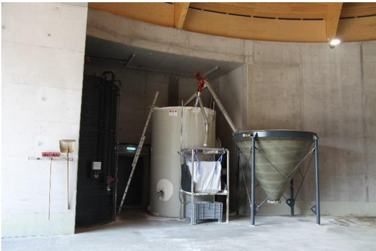
Streustoffhalle AM Efringen-Kirchen: Salzlöseanlage (Bild: Cypra)
