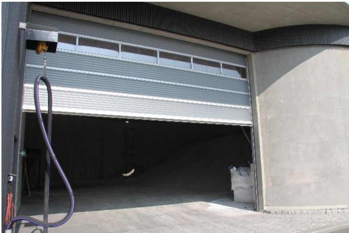
Streustoffhalle AM Efringen-Kirchen: Stapeltor beim Schließen (Bild: Cypra)
