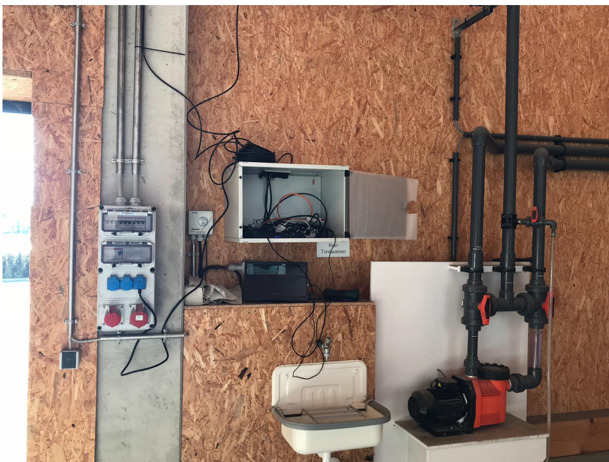
Stp Merklingen: Serverschrank in der Streustoffhalle (Bild: Holldorb)
