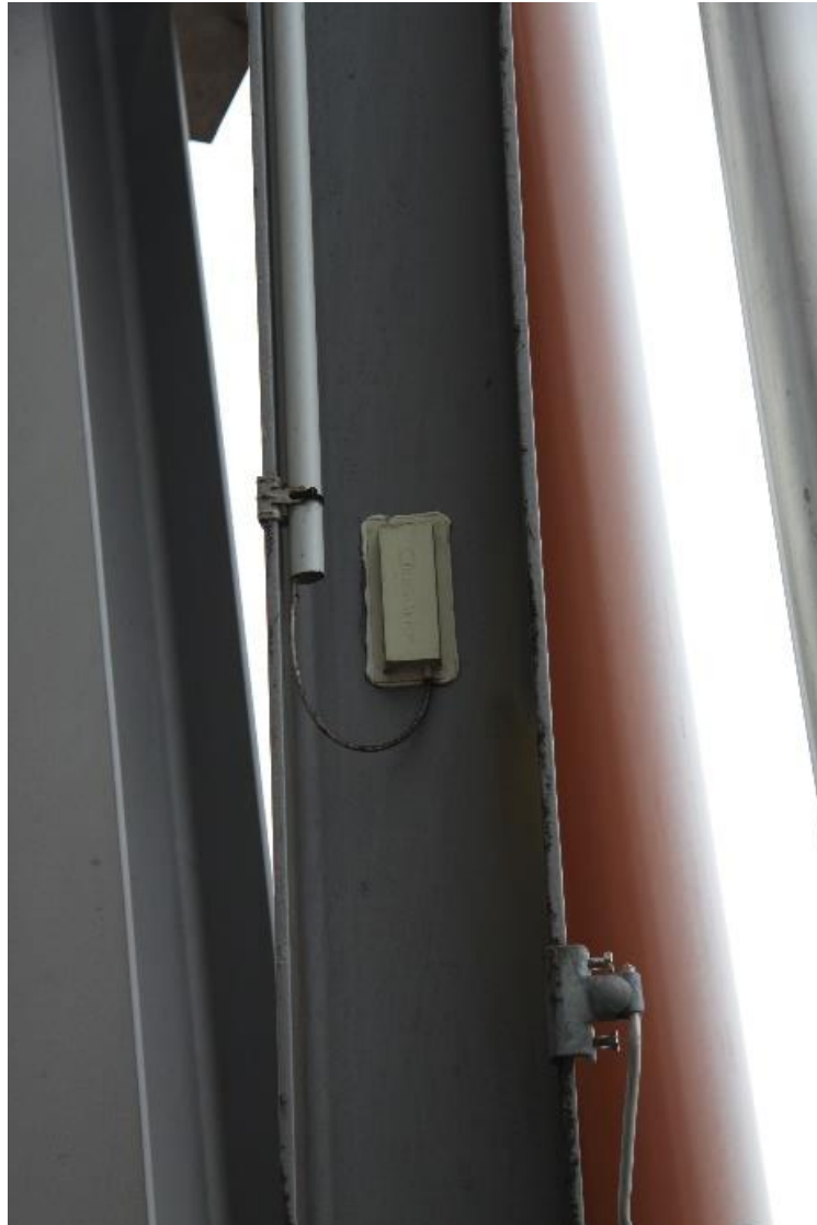
Streustoffhalle SM Northeim: Dehnmessstreifen an der Silostütze (Bild: Cypra)
