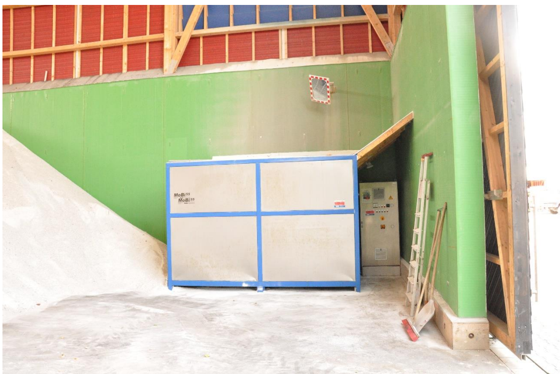
Streustoffhalle SAM Frankfurt: Salztrichter zur Befüllung des Verladesilos in der Streustoffhalle mit grüner BKU-Beschichtung der Hallenwand (Bild: Pape)
