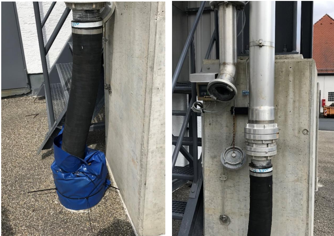
Streustoffhalle AM Reiskirchen: Anschluss des Zulaufschlauches aus Kunststoff an das Füllrohr zur Beschickung des Verladesilos (Bilder: Holldorb)
