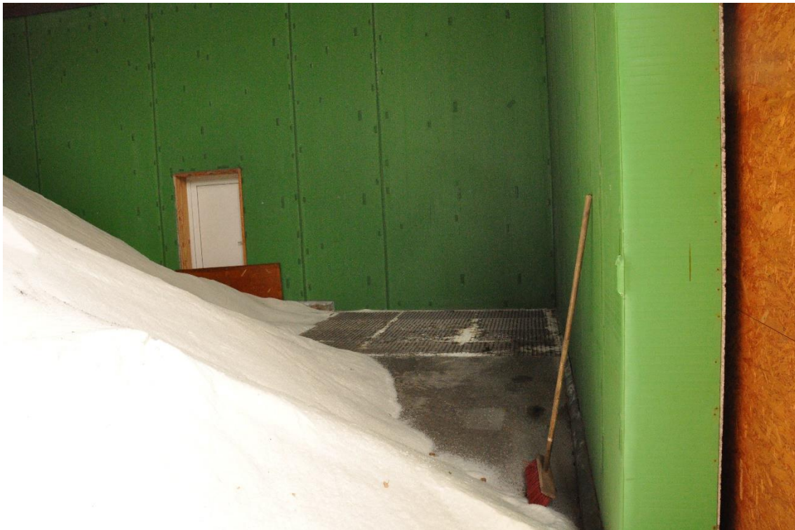
Streustoffhalle AM Reiskirchen: Bodeneinlass für die Beschickung des Verladesilos in der vorderen Hallenecke (Bild: Pape)
