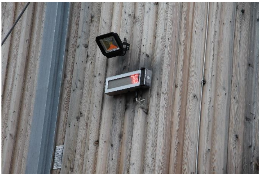
Streustoffhalle SM Northeim: Füllstandanzeige an Hallenwand (Bild: Cypra)
