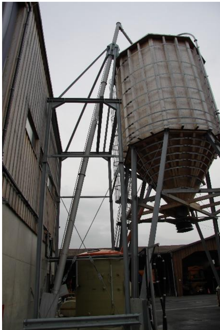
Streustoffhalle SM Northeim: Rohr mit Förderschnecke zur Befüllung des Silos (Bild: Cypra)
