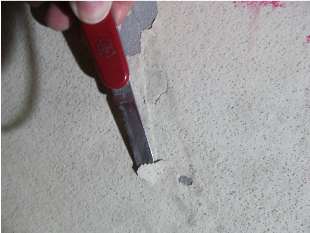
Bild 9 Verbundstörung zwischen Spachtel und hwO des Oberflächenschutzsystems im Rissbereich
