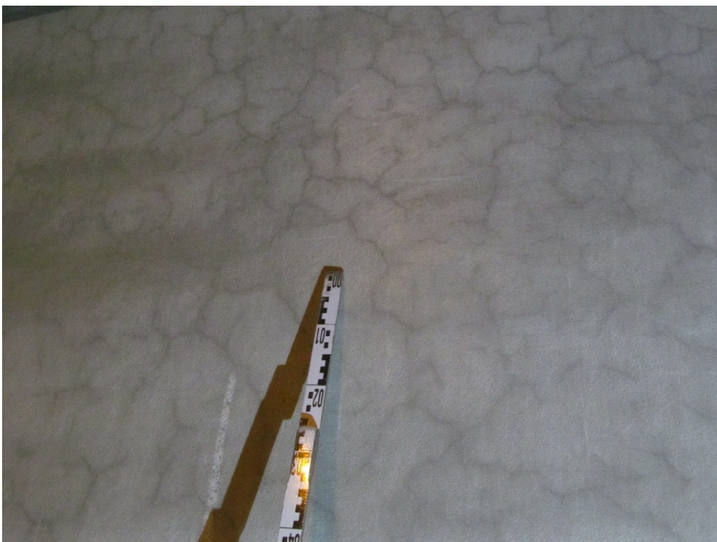
Bild 6 Netzrisse oben, Detail zu Bild 5
