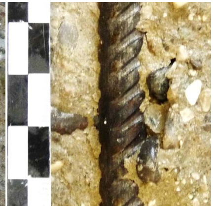
Bild 9: Stelle BK 8 ohne Korrosion
