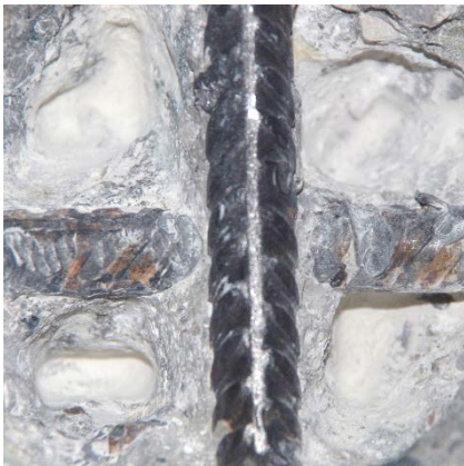
Bild 4: Stelle K 1 stellenweise angerostet
