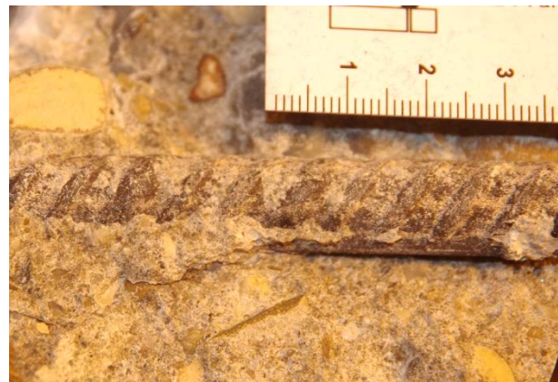
Bild 6: Stelle BK 2 ohne Korrosion
