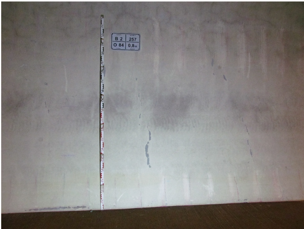
Bild 7 Block 84, Ost, Einzelrisse im unteren Bereich
