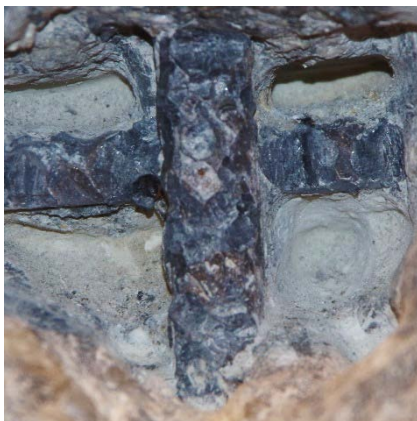
Bild 8: Stelle K 1 stellenweise angerostet
