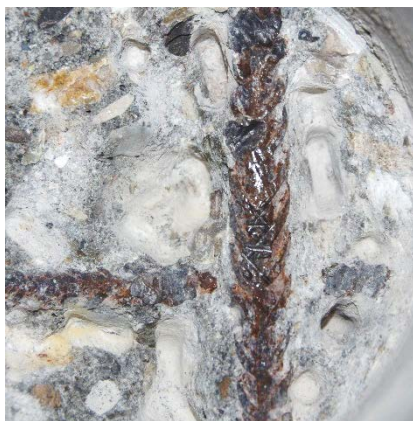
Bild 1: Stelle K 3 flächig angerostet
