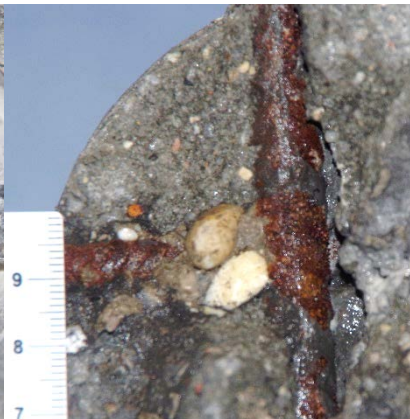
Bild 5: Stelle BK 1 Bewehrung rostet
