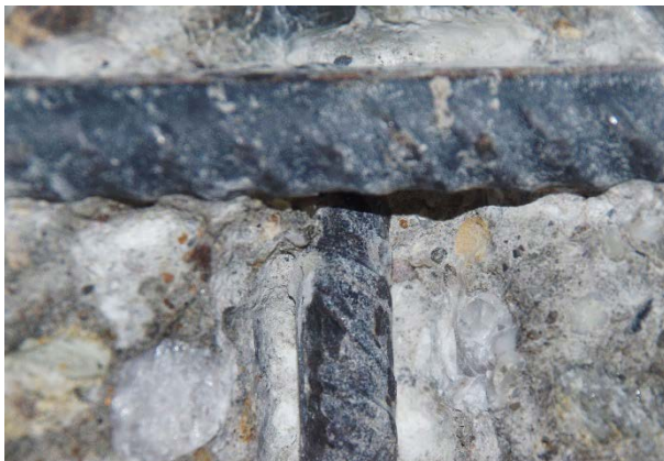
Bild 3: Stelle BK 7 ohne Korrosion
