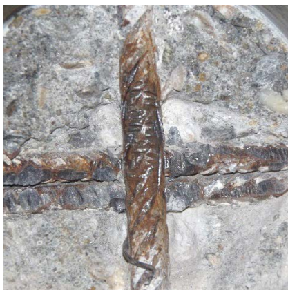
Bild 3: Stelle K 4 flächig angerostet
