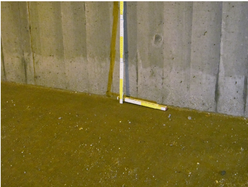
Bild 8 durchgehende Verfärbung am Wandfuß
