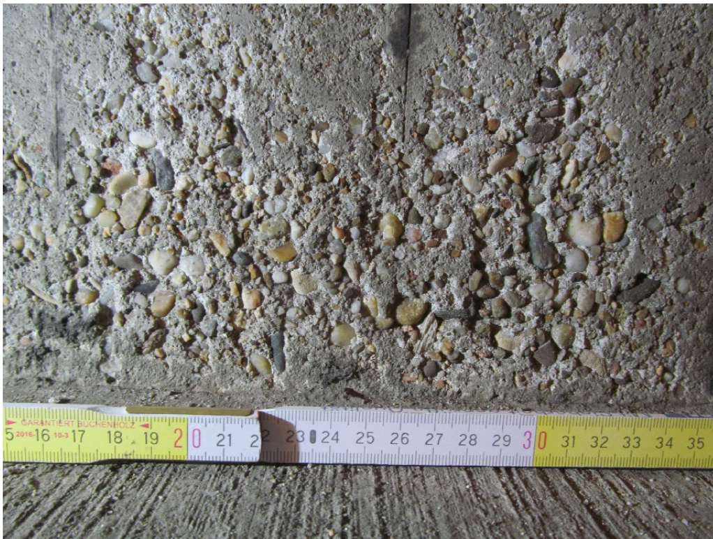
Bild 9 ausgeprägte Verwitterung am Wandfuß
