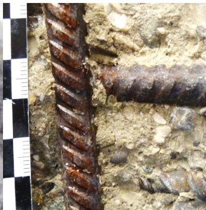
Bild 11: Stelle BK 5 Bewehrung rostet
