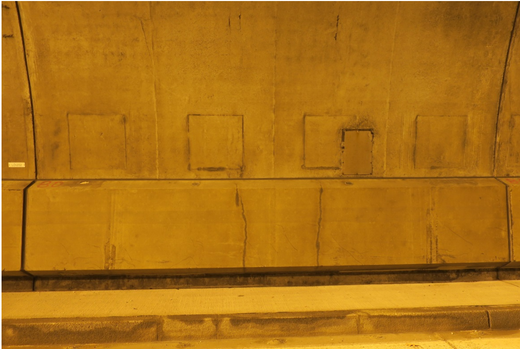
Bild 9 Freiliegende rostende Bewehrung, Block 80
