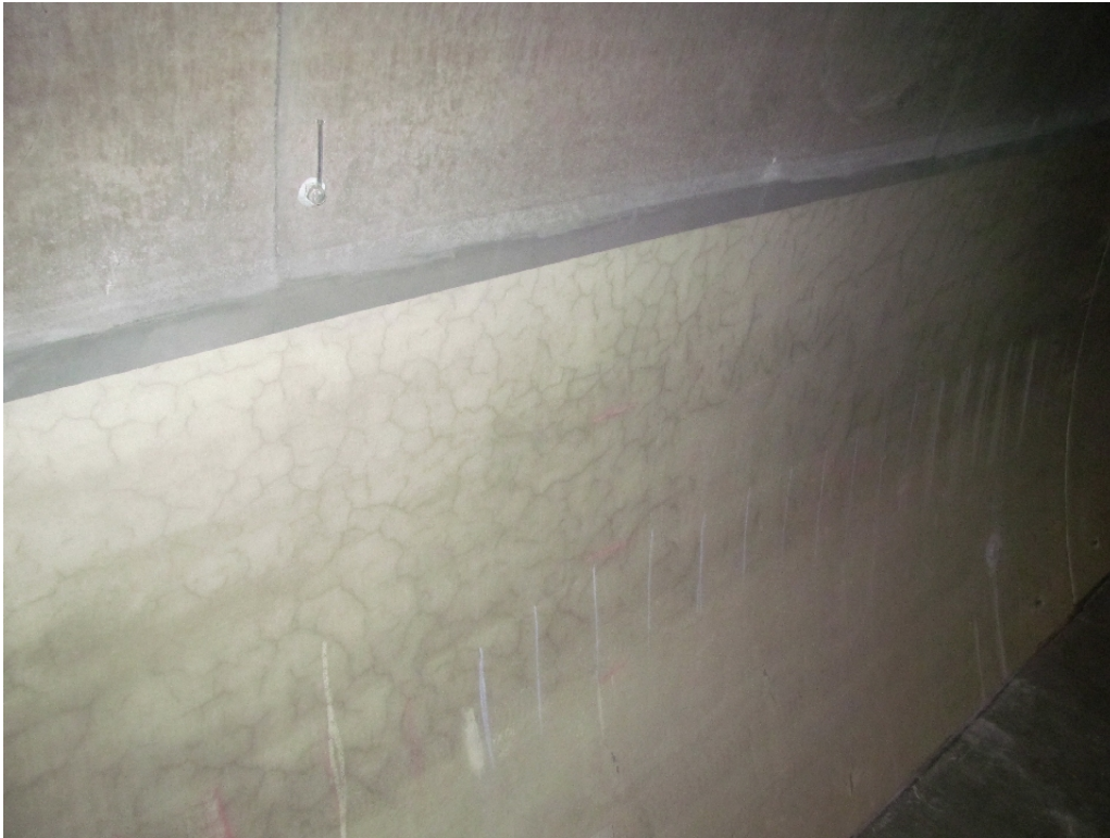
Bild 5 Netzrisse im oberen Bereich der Beschichtung
