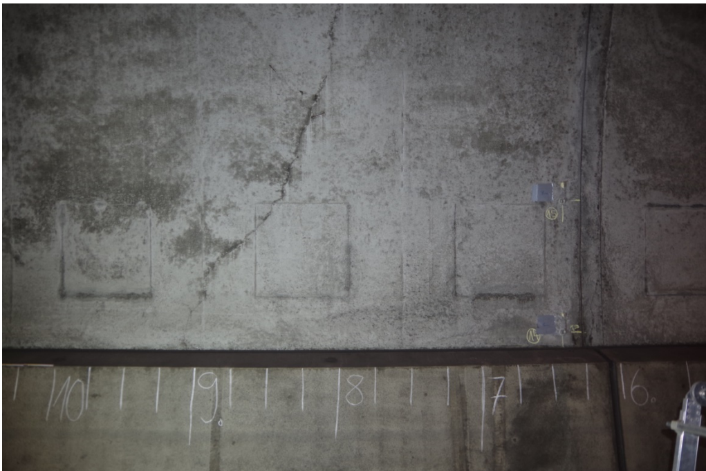
Bild 12 Schrägriss oberhalb des Leitungskanals
