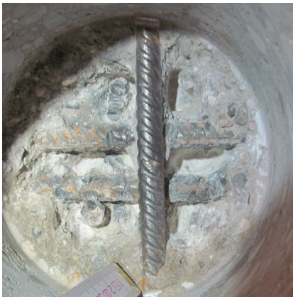
Bild 1: Stelle K 2 stellenweise angerostet
