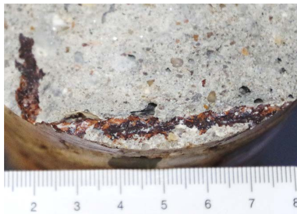
Bild 2: Stelle BK 4 Bewehrung rostet
