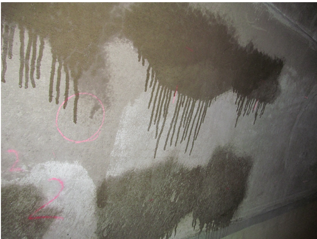
Bild 10 Benetzungsverhalten des Betons oberhalb des beschichteten Bereiches
