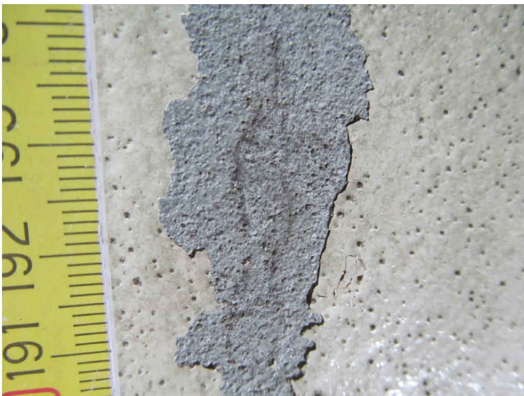
Bild 8 Beschichtung abgeplatzt, Detail zu Bild 7
