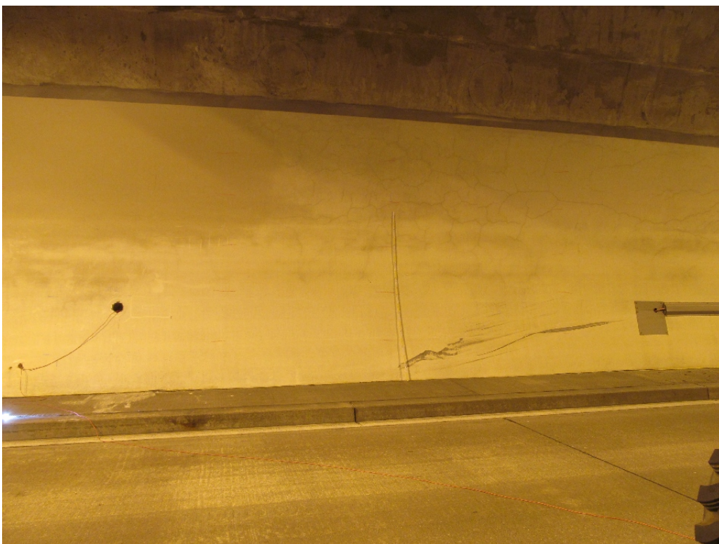
Bild 4 Tunnel Farchant, Beschichtung beschädigt durch Fremdeinwirkung
