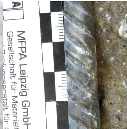
Bild 8: Stelle BK 7 ohne Korrosion
