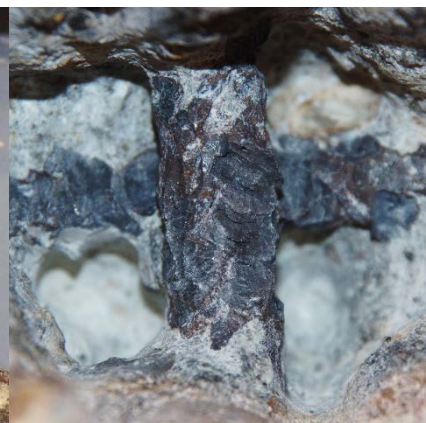
Bild 12: Stelle K 2 flächig angerostet
