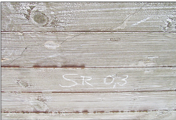
Bild 10: Beispiel typischer Störquellen – Holzmaserung auf der Betonoberfläche [Foto: TLBV]
