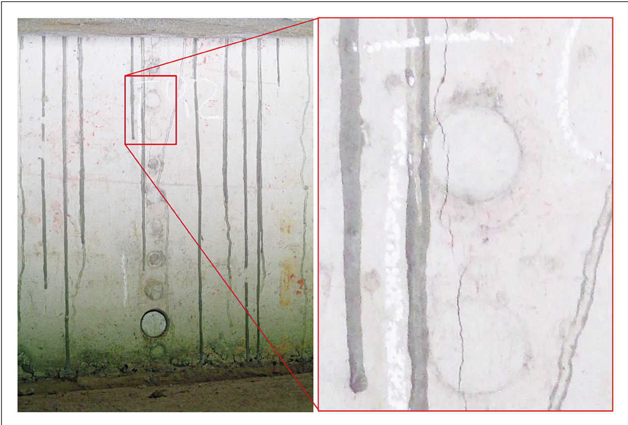
Bild 9: Beispiel typischer Störquellen – Linienhafte Strukturen auf der Betonoberfläche [Foto: TLBV]
