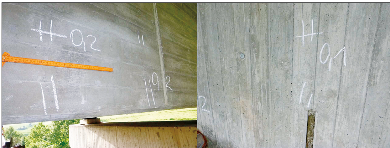
Bild 29: Beispielhafte Schadensbilder aus dem aktuellen Zustandsbericht, Querrisse am Überbau (links) und Längsrisse am Pfeiler (rechts) [Foto: TLBV]
