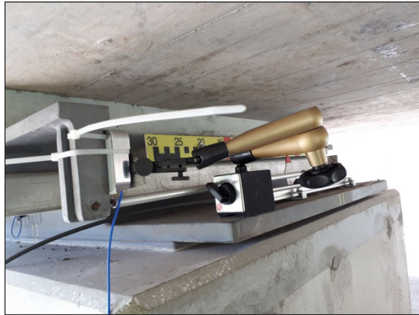
Bild 124: Temporär befestigter Wegsensor mit Messbereich 0...2 mm
