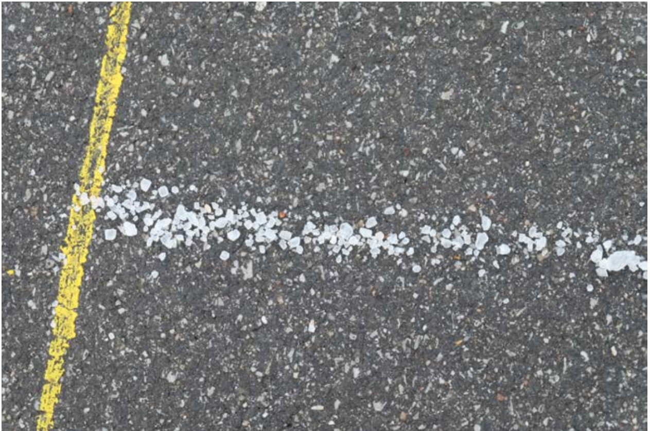
Bild 28: Blick auf das entmischte Salz im Überwurfbereich links
