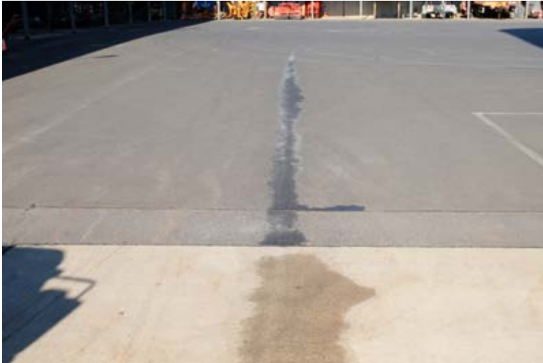
Bild 10: Blick auf die ausgelaufene Sole
