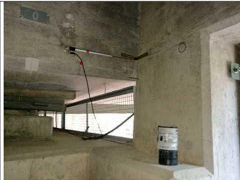
Defekter Wegaufnehmer „W längs 1.2.2“ Hangbrücke Würgau
