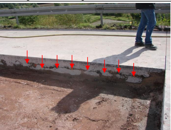
e. Erkennbarkeit Horizontalriss in Längsfuge zwischen 1. Fahrstreifen und Standstreifen in Höhe der Anker
