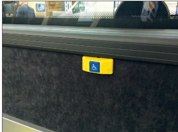
Bild 39: Kommunikationseinrichtung am Rollstuhlstellplatz (uni-direktional)
