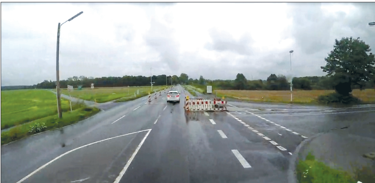
Bild 19: Warnung auf eine Baustellenabspernung auf der Fahrbahn
