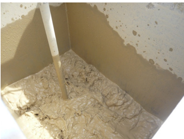
Rührbecken der Anlage zur Einstellung des jeweils geforderten Wassergehalts
