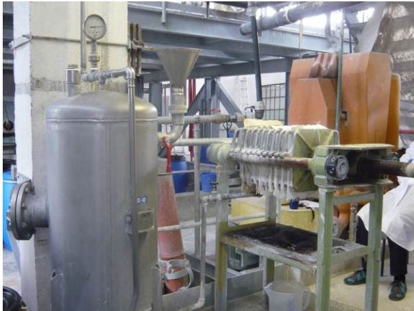
Anlage mit Einfüllstutzen für Suspensionsbehälter mit Manometer
