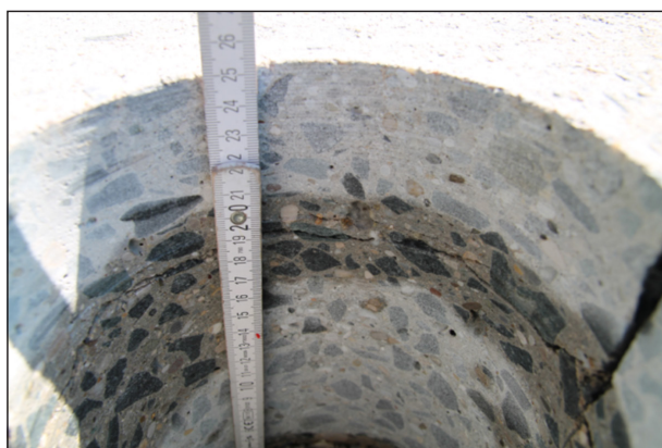
Bild 49: Ansicht der Bohrlochwand einer Kernbohrung an der Fuge der Messung in Bild 48. Auf der Höhe des Kerbschnittgrundes ist ein deutlicher Riss erkennbar.
