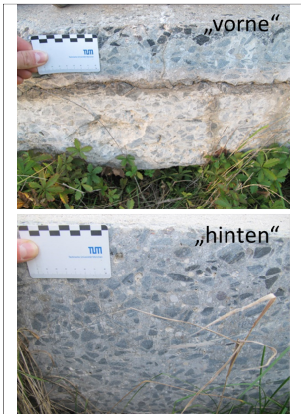
Bild 40: Visueller Befund an den Schnittkanten der Ausbauplatten („Vorne“: Start des Messprofils)
