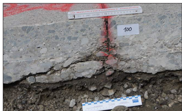
Bild 53: Rissbildungen an Plattenunterseite im linken Fahrstreifen (Foto: Autobahndirektion Südbayern)
