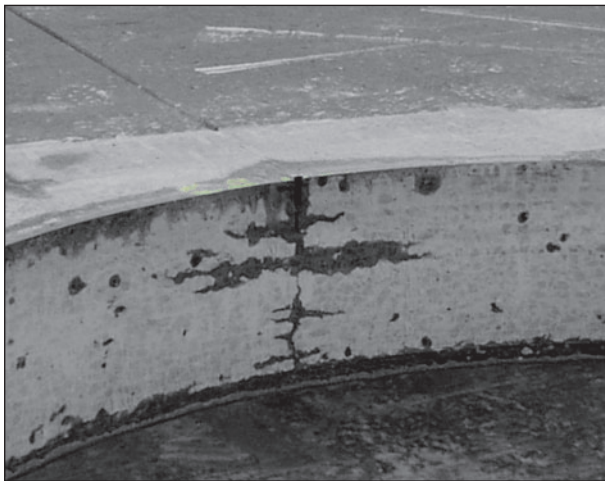
Bild 8-3: Horizontaler Riss am Plattenrand
