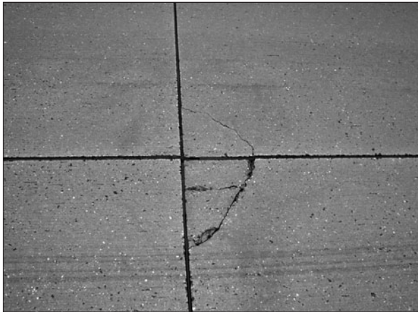
Bild 8-2: Eckabbruch an einer Betonfahrbahnplatte
