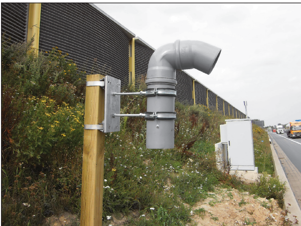
Bild 4.7: Messcontainer (Hintergrund) und Passivsammler (Vordergrund) an dem beschichteten Teil der Lärmschutzwand an der A 1
