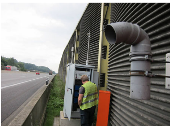
Bild 6: Standort Süd , Messstation SE1 , an der unbeschichteten Teilstrecke innerhalb der Lärmschutzwand, Blickrichtung Nordosten.
