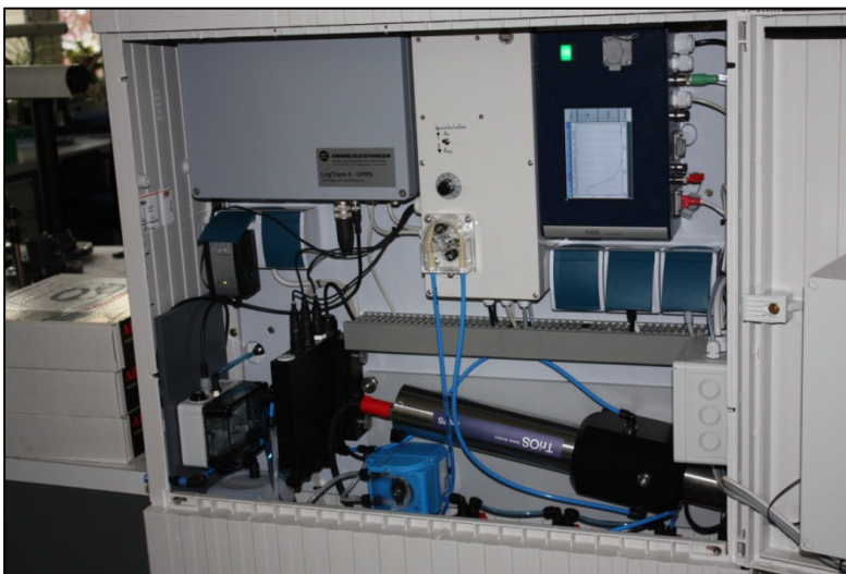
Abb. 2.10 Messstation 4 mit zusätzlicher UV-Sonde (unten rechts) und Auswerteeinheit mit Touchpanel (oben rechts).
