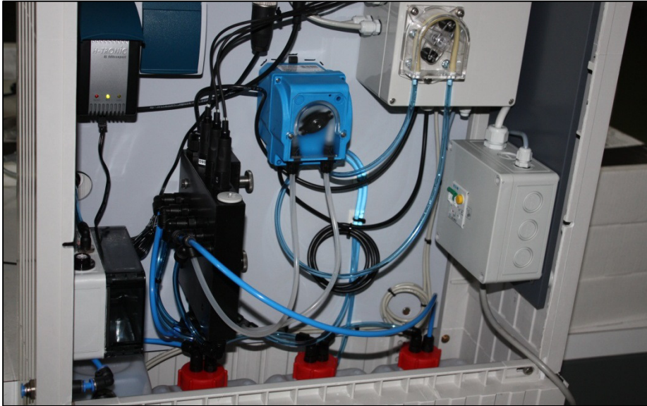
Abb. 2.20 Nachrüstung der Messstationen mit blauer Rezirkulationspumpe
