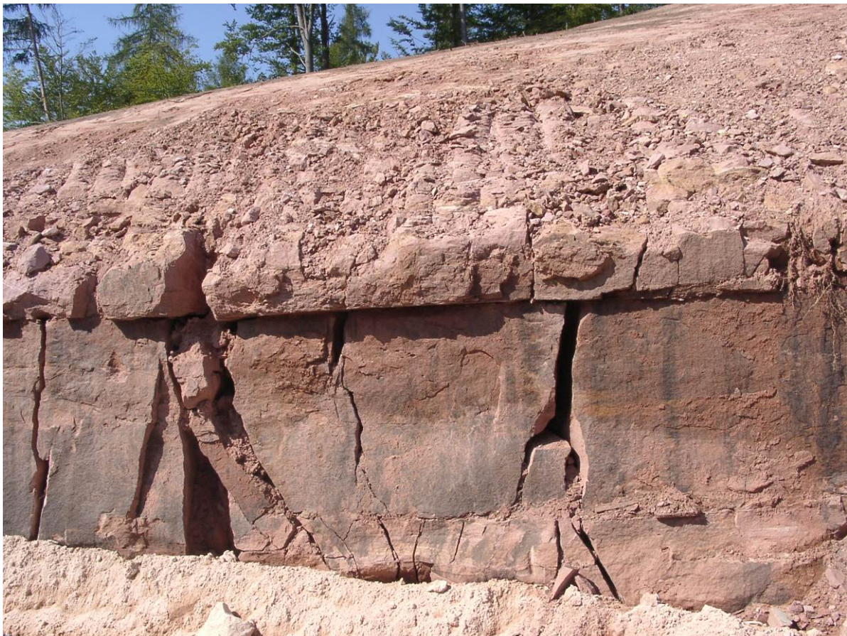
Bild 5 / A-4: Buntsandstein im unteren Böschungsbereich liegt als stark geklüfteter Fels vor (Kluftbreite bis 0,5 m)
