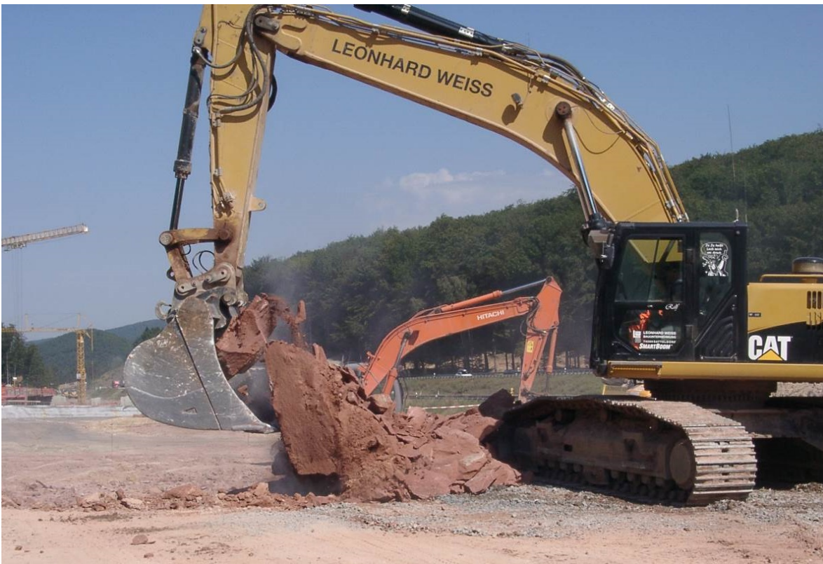
Bild 6 / A-4: Lösen von Gesteinsbrocken mit einer Kantenlänge bis 2,0 m mittels Bagger (Baggerschaufel mit Reißzähnen), ggf. Vorzerkleinern mittels Meißel
