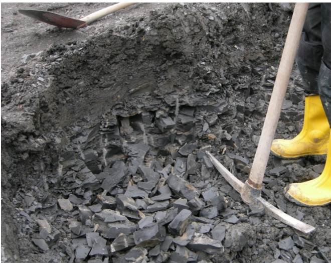
Bild 4 / A-2: Abräumen der verwitterten Schichten bzw. Einwirkungsbereich Frost/Witterung
