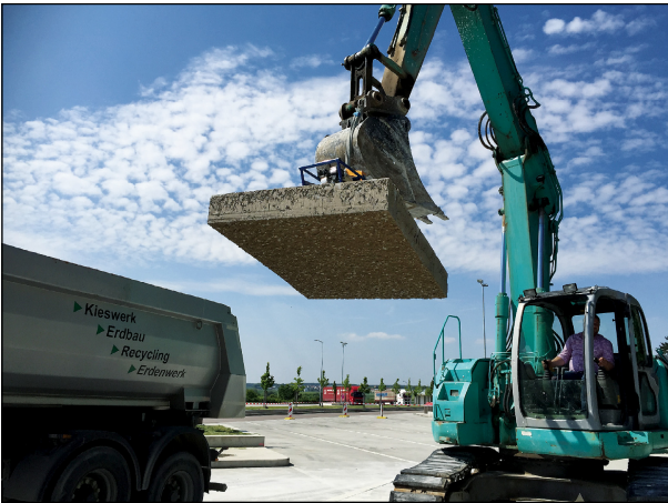
Bild 36: Anhaftendes Baustoffgemisch an der Unterseite der Plattensegmente
