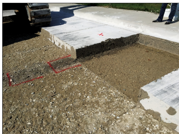
Bild 39: Feinanteile im unverdübelt und unvergossenen Fugenbereich. Anmerkung: Die Querscheinfuge wurde zum Abheben der Plattensegmente nicht nachgeschnitten
