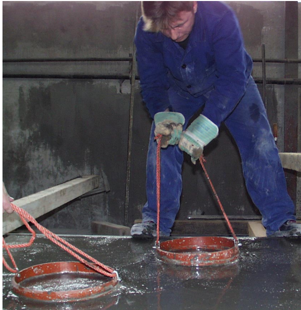
Bild 63. Betonieren des Probekörpers und der Chloridnester. Nach kurzer Abbindezeit wurden die Kunststoffrohre der Chloridnester herausgezogen.
