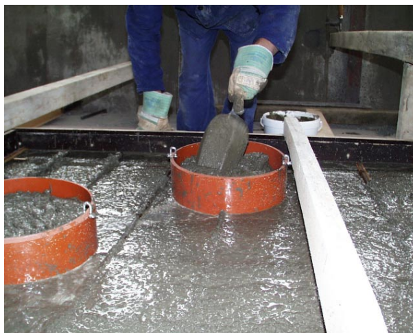
Bild 62. Betonieren des Probekörpers und der Chloridnester. In die Kunststoffrohre wird jeweils eine separat mit unterschiedlichem Salzgehalt präparierte Betonmischung eingebracht.
