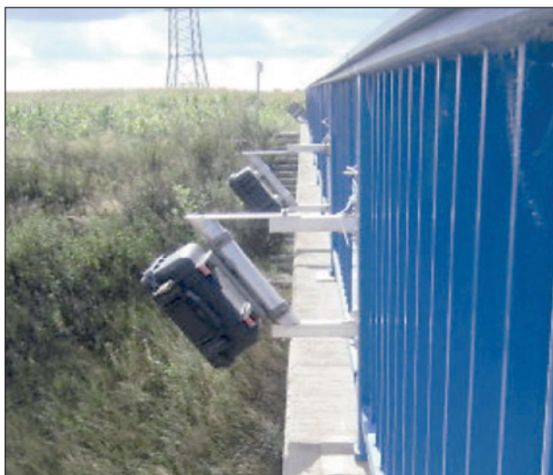
Bild 15 : An einem Brückengelände installierte Radargeräte über der Fahrbahn der BAB A4
