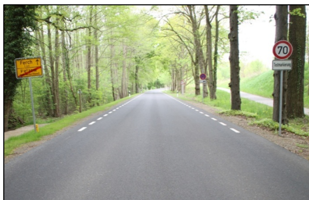
Bild 329: Übergangsbereich an der Ortstafel Petzow
