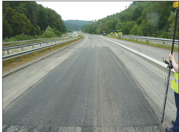
Bild 2.5: Eingemessene Flickstellen auf der Bundesstraße B 10
