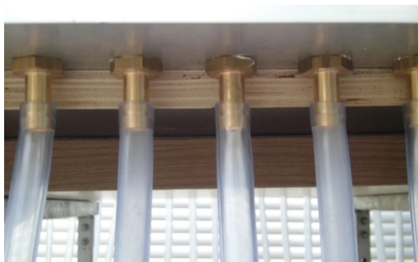
Bild 30: Schlauchstutzen mit aufgestülpten PVC-Schläuchen
