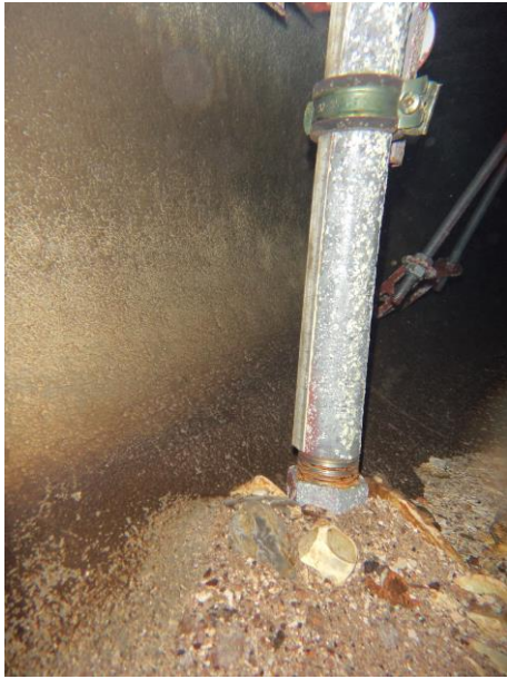
Abbildung 2: Halterung Duo-Sonde in der Westulmendrainage, Blick stromaufwärts
